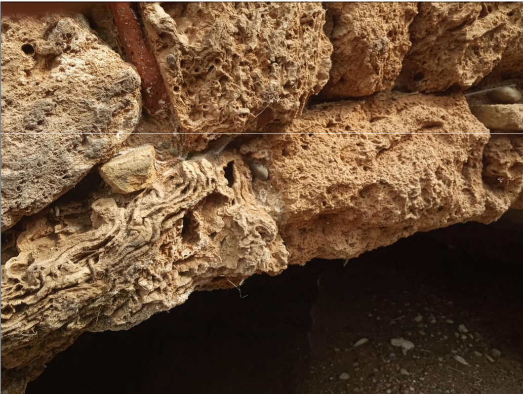
Degradació dels blocs de la volta de canó de la cara oest
