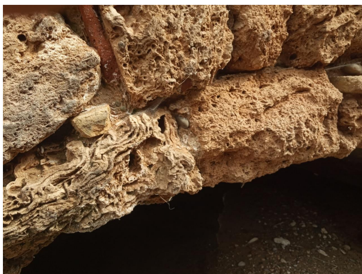
Detall estat de les dovelles. Tríade
