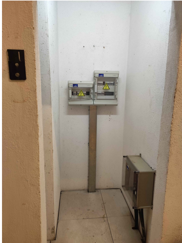
Sala seccionadors estació Gorg
