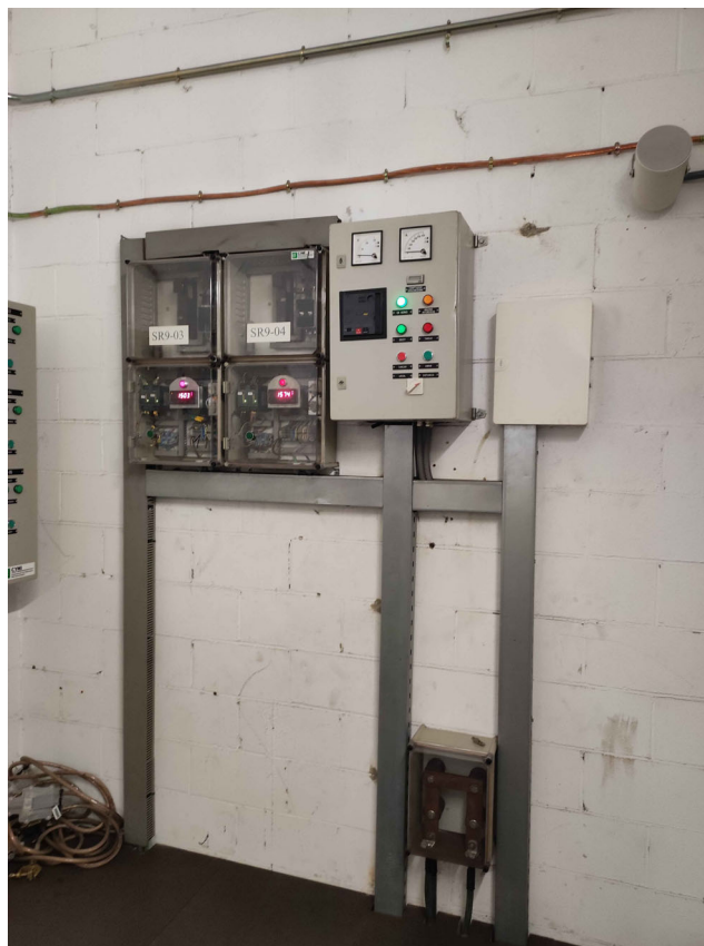
Sala seccionadors estació Santa Rosa
