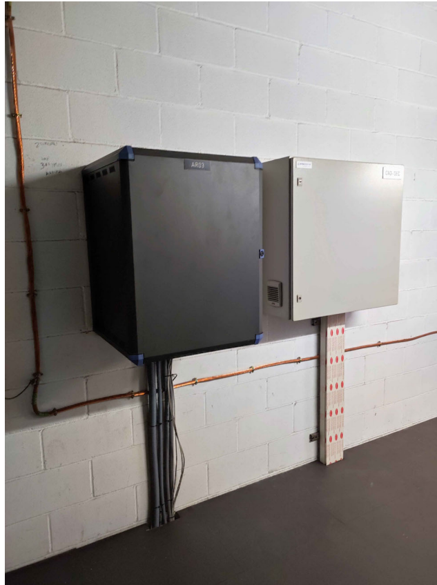
Sala seccionadors estació Fondo - Rack i CN3
