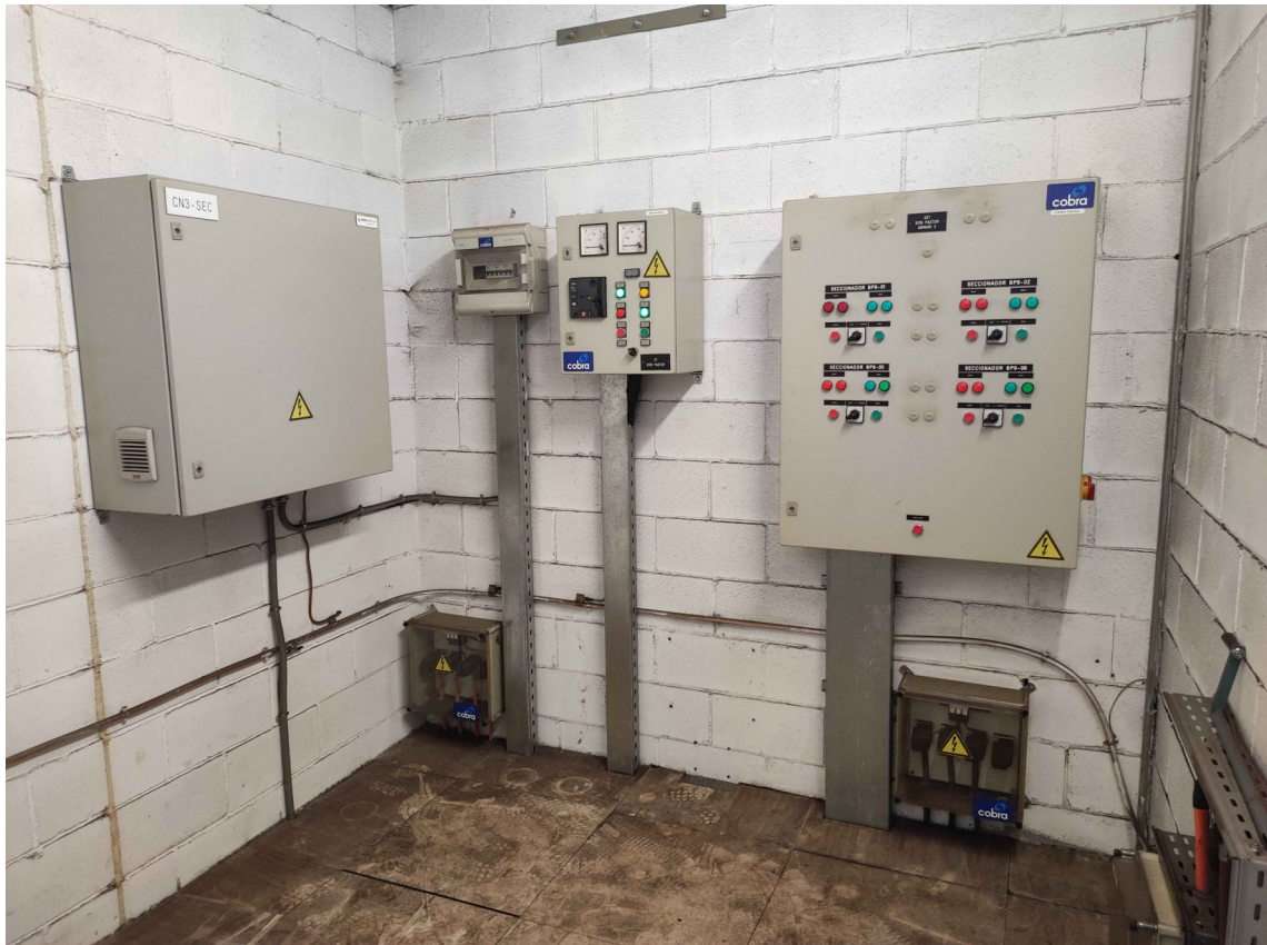
Sala seccionadors estació Bon Pastor
