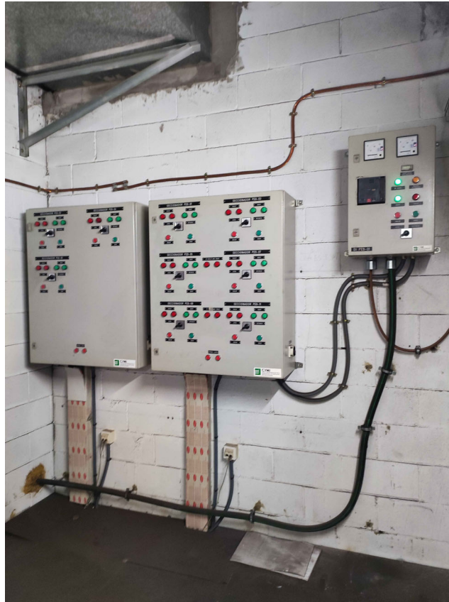
Sala seccionadors estació Església Major
