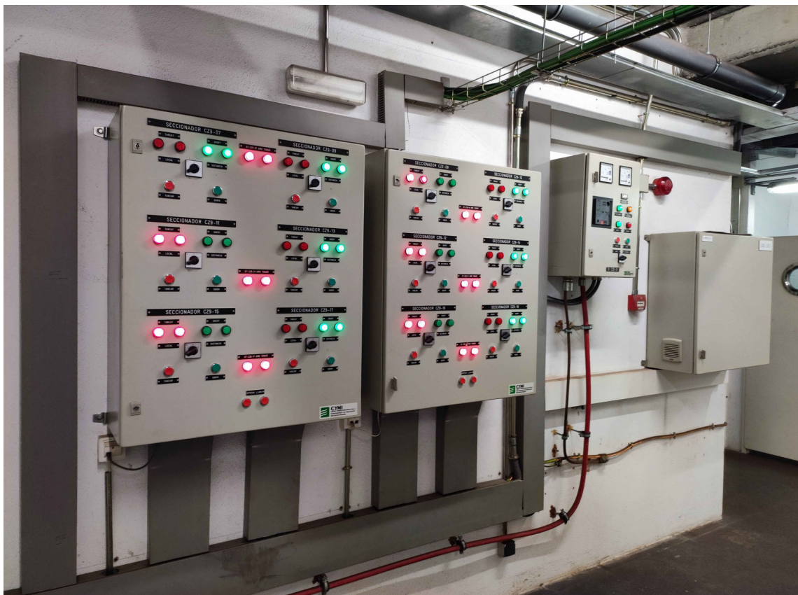
Sala seccionadors estació Can Zam
