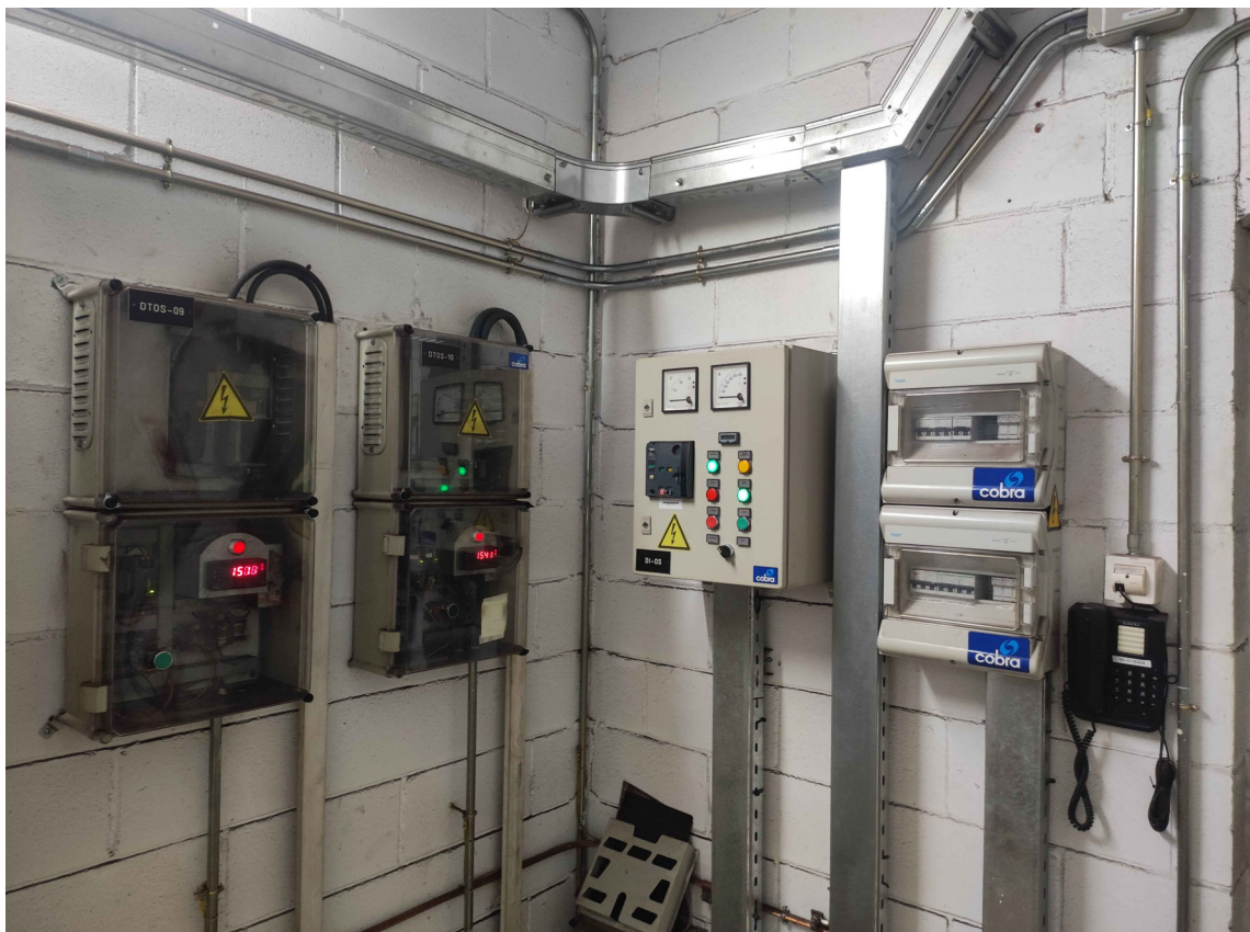
Sala seccionadors estació Onze Setembre
