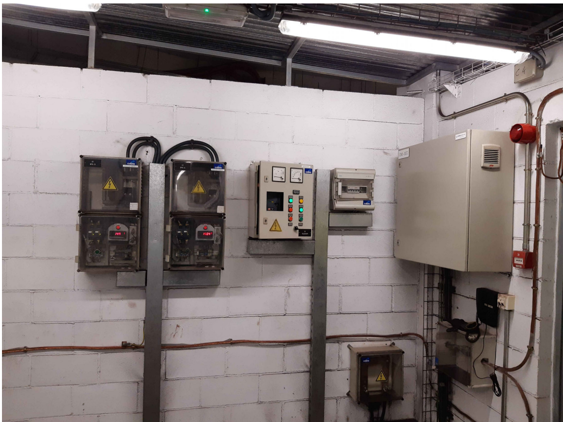
Sala seccionadors Pou de ventilació Bon Pastor (Pou rodó)
