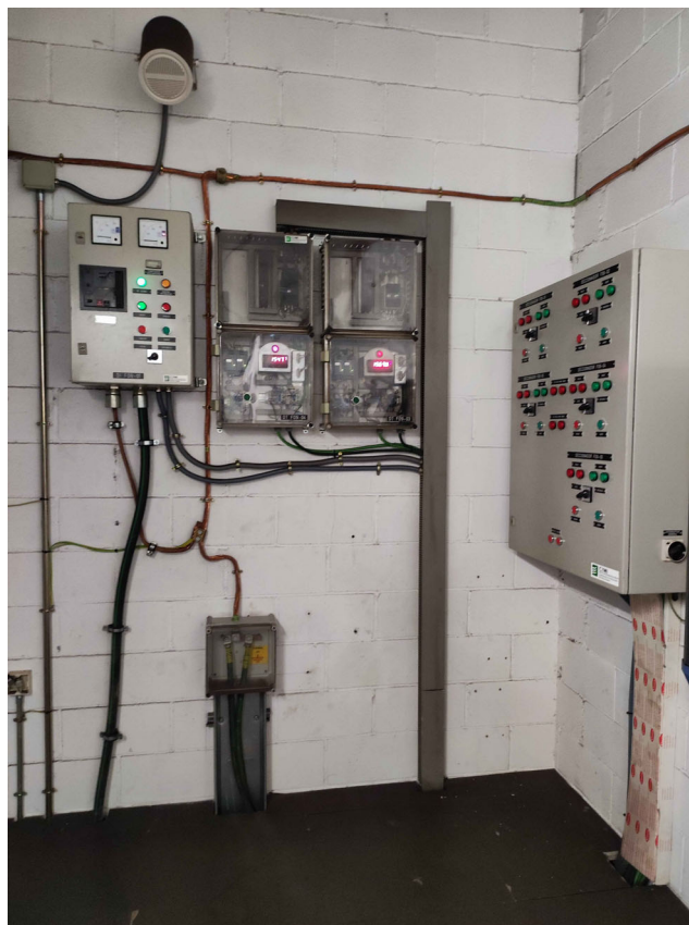
Sala seccionadors estació Fondo
