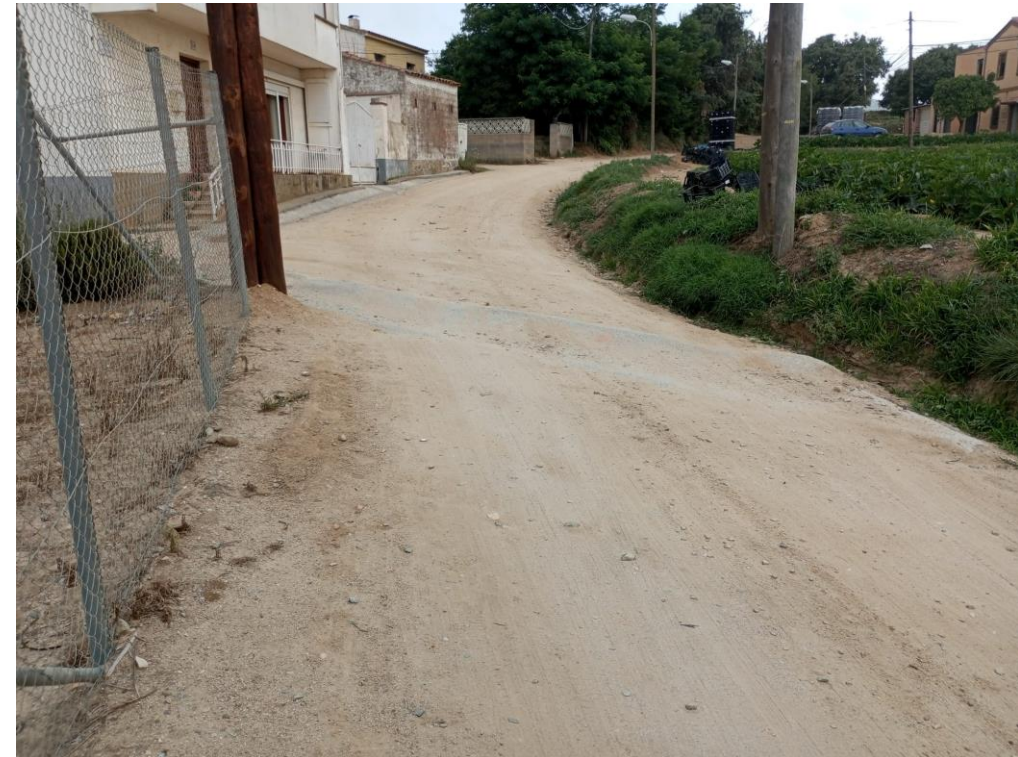
Fotografia 5. Trenca de formigó prop de l'inici del carrer asfaltat de la zona esportiva
