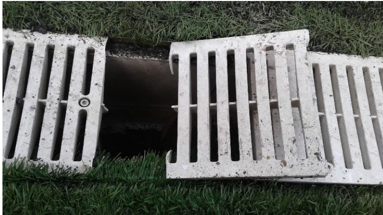
Mostra de reixa metàl·lica per substituir les trencades de fibra.
