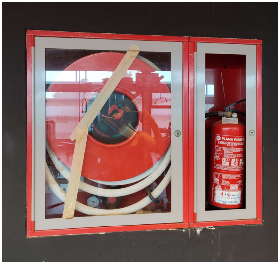
Planta primera. Sala musculació. La BIE te el vidre trencat i l'extintor no te vidre
