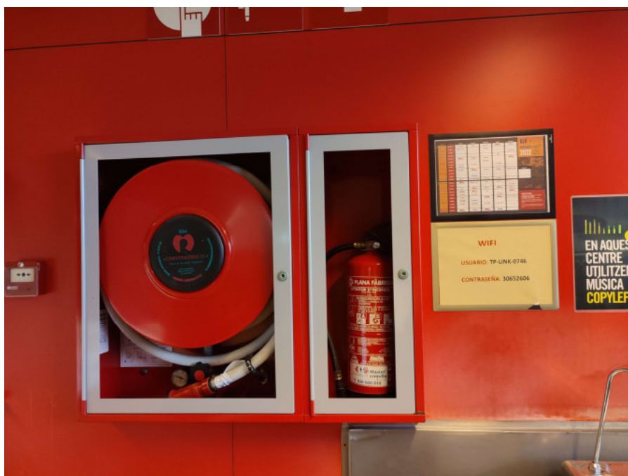
Planta primera. Sala fitness. Li falta el vidre de la BIE
