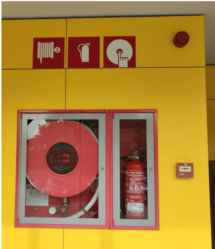
Planta baixa. Passadís. La BIE te el vidre trencat. Els rètols no són normatius
