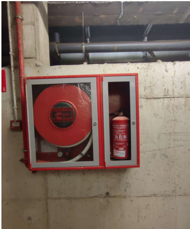
Planta soterrani. Sota piscina. La foto de dalt, extintor costat dipòsit pellets, no té rètol. La foto d'abaix falta el rètol i el vidre a l'extintor.
