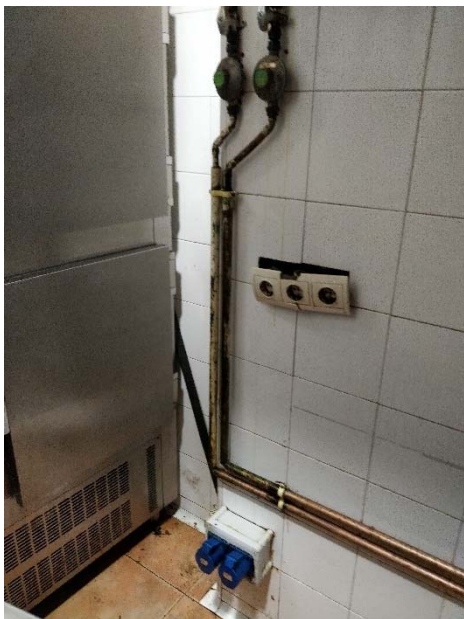
Instal.lacions existents cuina
