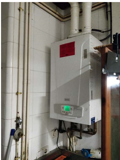
Instal.lacions existents cuina
