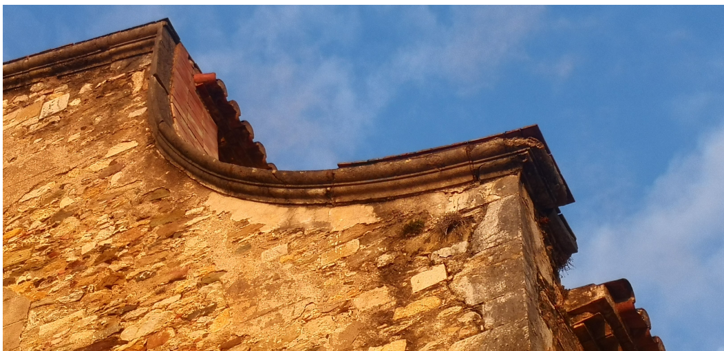
Detalls estat cornisa de coronament de la façana
