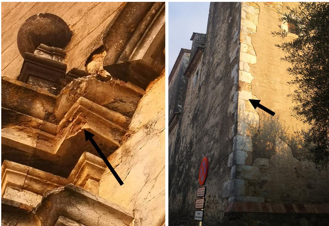
Restitucions puntuals recents amb ceràmica i/o morters de ciment
