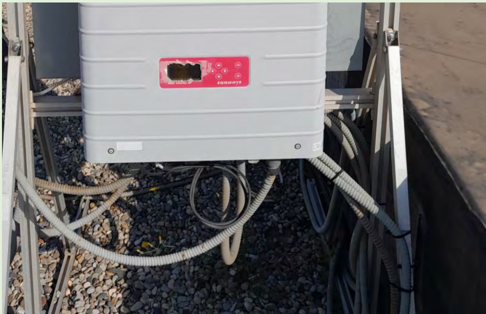
Degradació del display d'un inversor degut a l'exposició solar directa.
