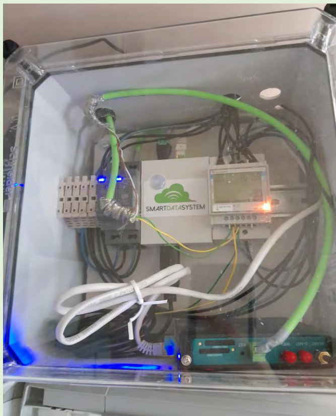
Exemple de caixa amb equips de monitoratge i poca ventilació.
