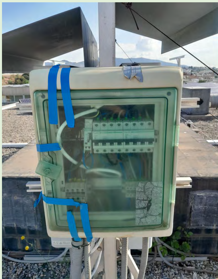
Exemple de quadre elèctric degradat per l'acció solar.
