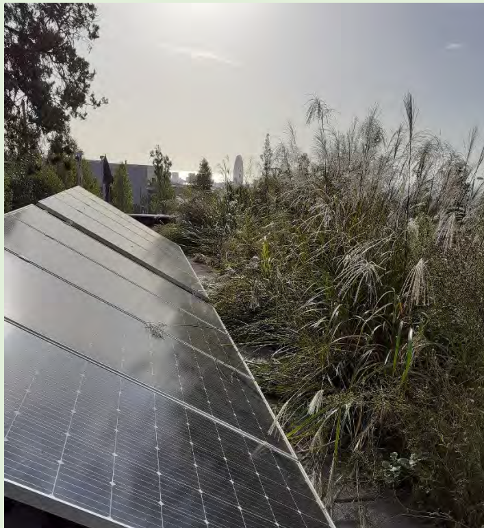
IESFV integrada en coberta "verda" amb vegetació molt propera.
