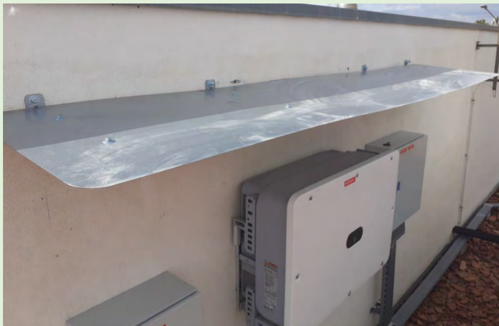
Petita coberta per la protecció de l'inversor i els quadres de protecció.
