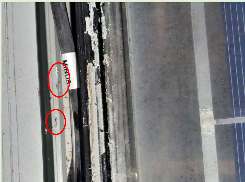
Exemple d'una execució poc acurada on es pot observar l'arrencada de material a prop de l'allotjament del cablejat. S'ha d'evitar fer malbé l'aïllament en l'execució.
