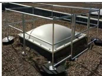
Figura 3. Ejemplo protección claraboyas con barandilla
