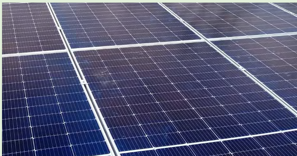
Foto d'exemple de dos mòduls a tocar un amb l'altre sense espai lliure de dilatació.
