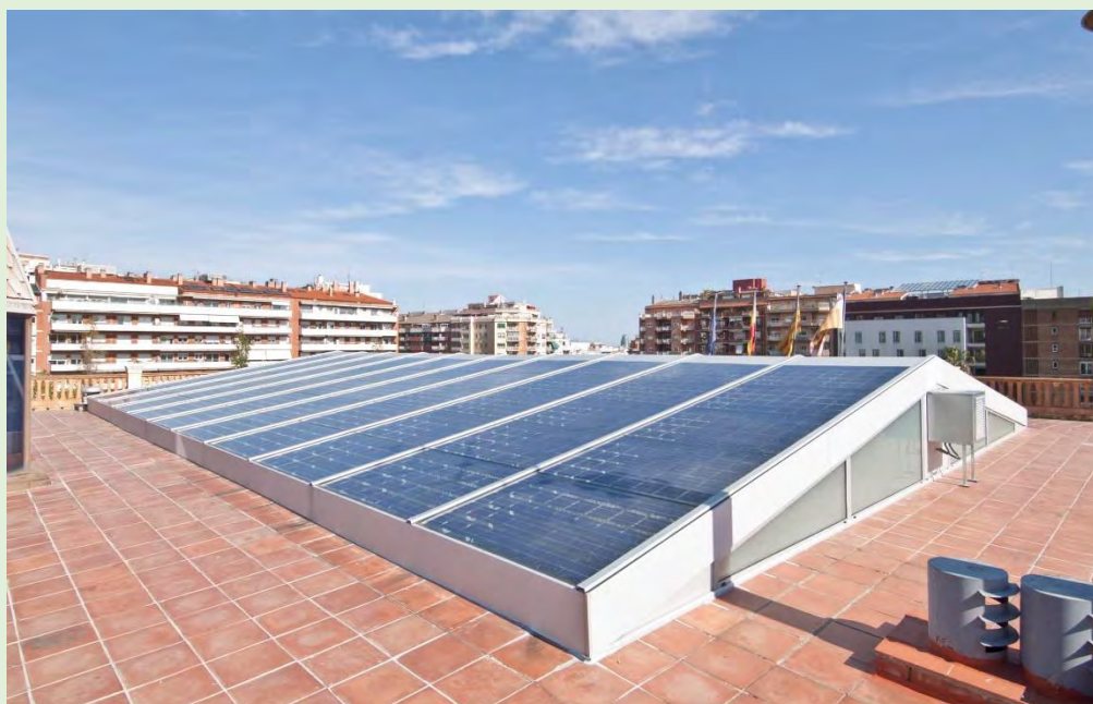
Cas real d'un lluernari amb panells vidre vidre
