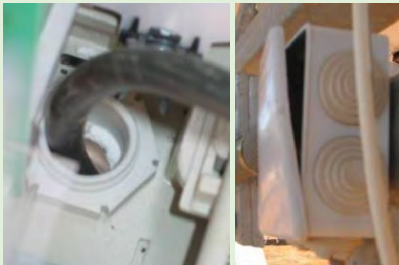
Exemple de caixes que perden el grau de protecció IP degut a una mala execució.
