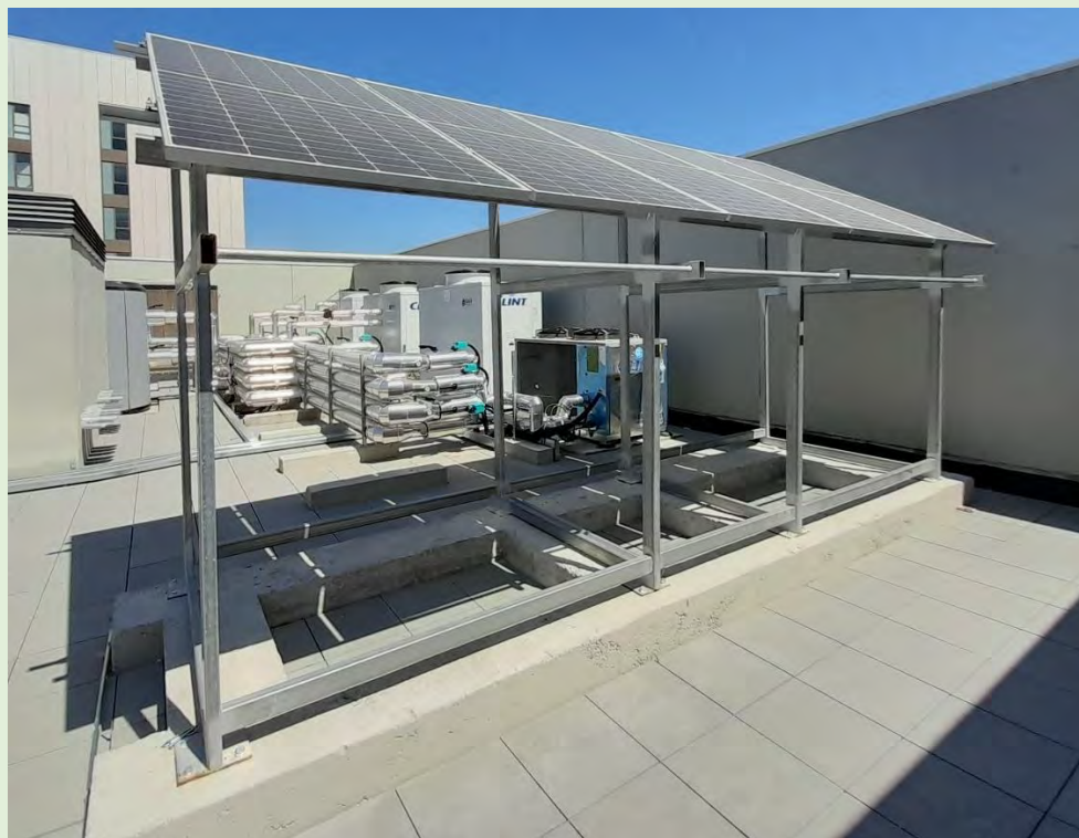
Subestructura construïda per evitar les ombres d'un mur. És necessari certificació emès per tècnic competent.
