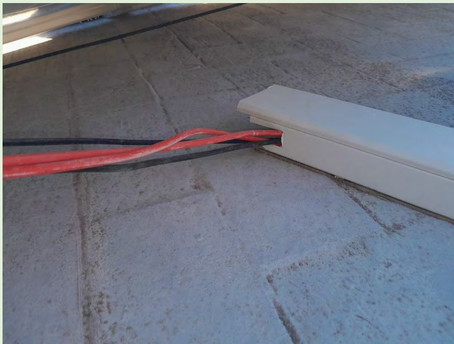
Exemple d'instal·lació on es troba que el cablejat esta tibant.
