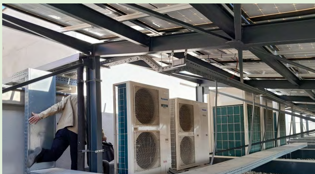
Màquines de clima amb expulsió de calor cap als mòduls.
