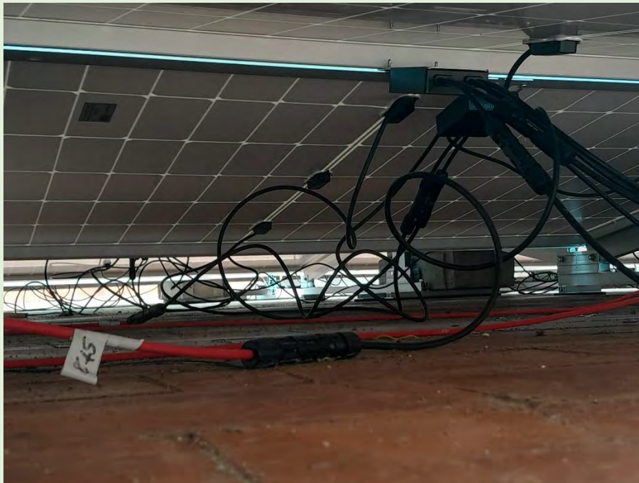
Exemple de cablejat desordenat sota els mòduls que han de quedar recollits pel marc de la placa per evitar el deteriorament prematur. Estanqueïtat d'aigua en estar en el pas de l'aigua i/o possibles sobreescalfaments del MC4 sobre la teula.
