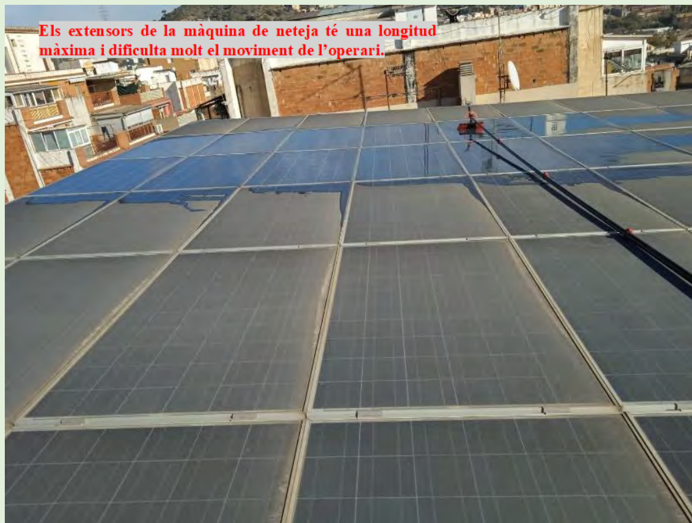
Pèrgola de 3m d'alçada sobre la coberta d'un edifici on no s'arriba a netejar el mòduls finals.
