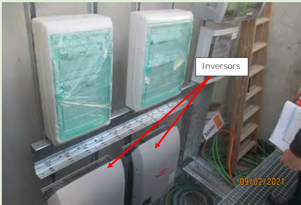
Inversors instal·lats a l'altura dels peu. La manipulació dels equips pel personal de manteniment es fa costos.
