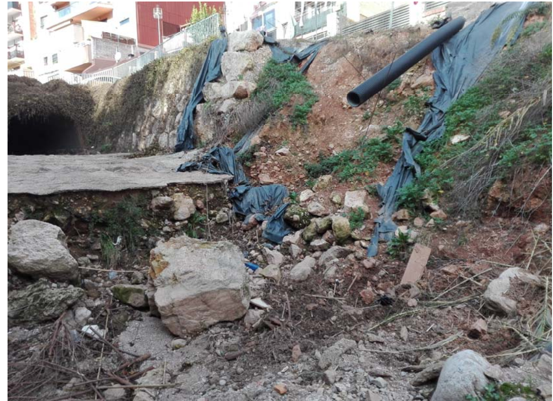
5. Esllavissada del talús al marge esquerra de la riera a restaurar
