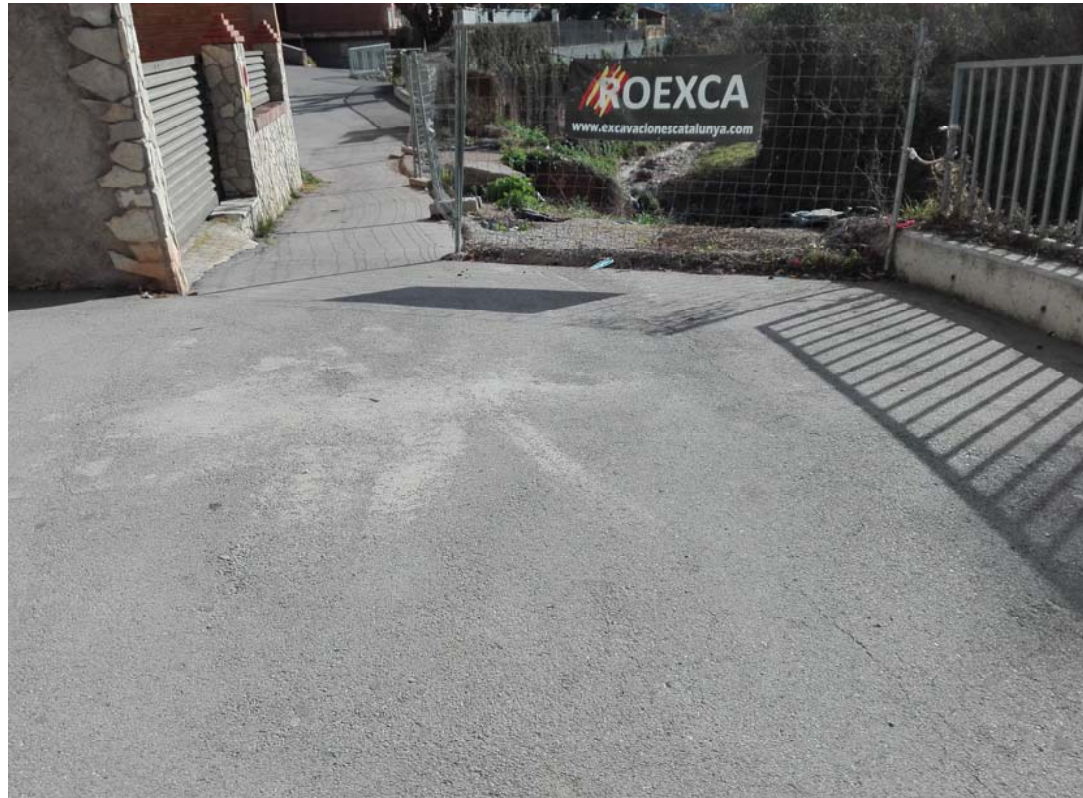
11. Vista del carrer Vinyes, zona afectada per l'esllavissada del talús (restauracions de: nivell de la rasant, paviment, vorada i barana de protecció)
