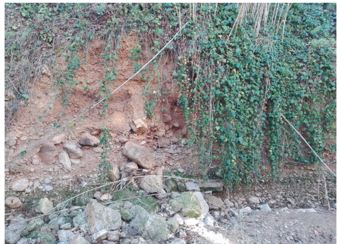
6. Esllavissada del talús al marge dret de la riera a restaurar
