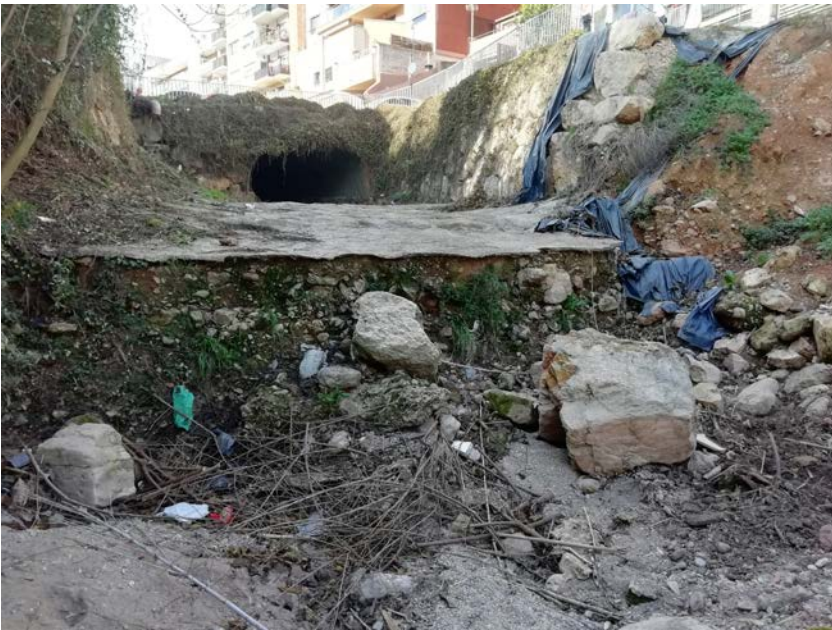
Figura 1. Erosió local originada al final del tram d'escullera formigonada
