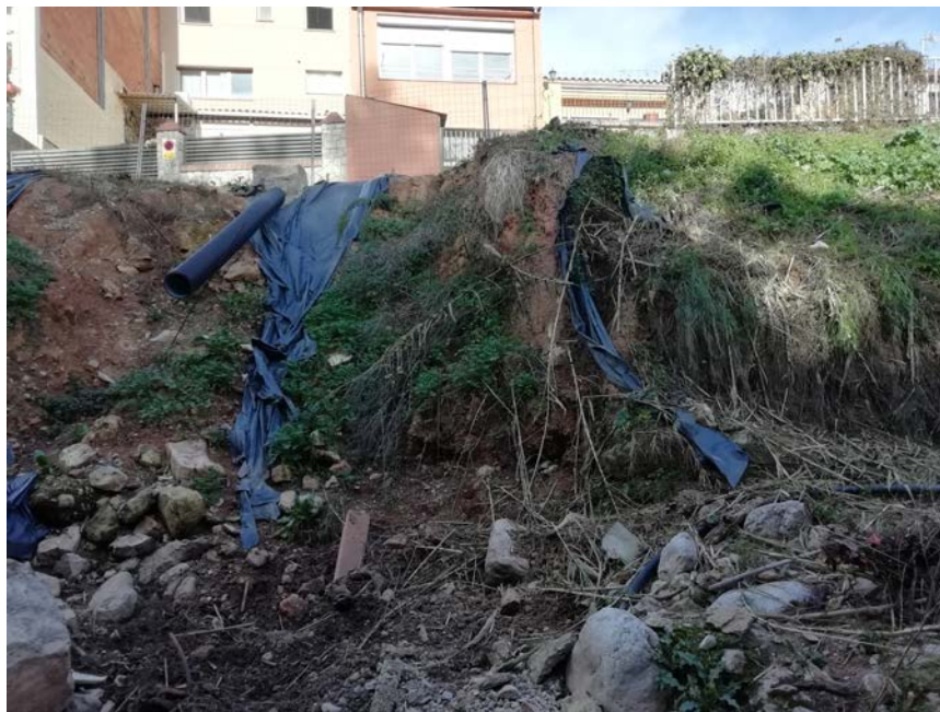
Figura 2. Despreniment del talús del marge esquerre originat a conseqüència del descalç del talús provocat per l'erosió local de la llera
