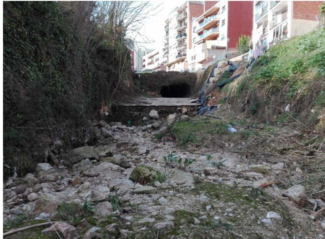
3. Vista general de la llera a la zona afectada per l'esllavissada del talús
