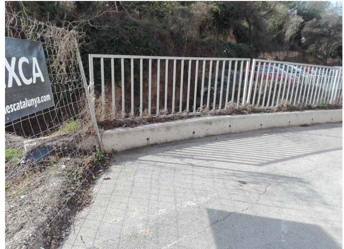
13. Vista del carrer Vinyes, detall de la vorada i barana de protecció del carrer existent a restaurar al tram afectat per l'esllavissada
