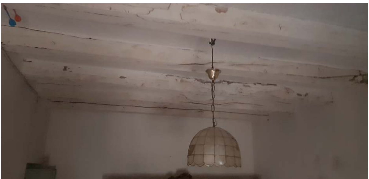
Estat del sostre planta segona
