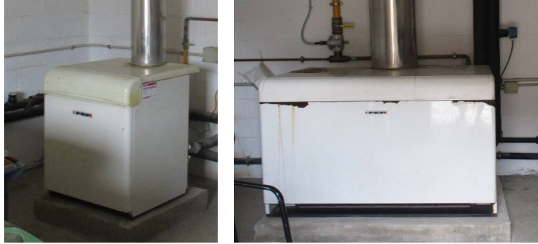
Fotografia de les calderes existents de 40kW i 243 kW respectivament
