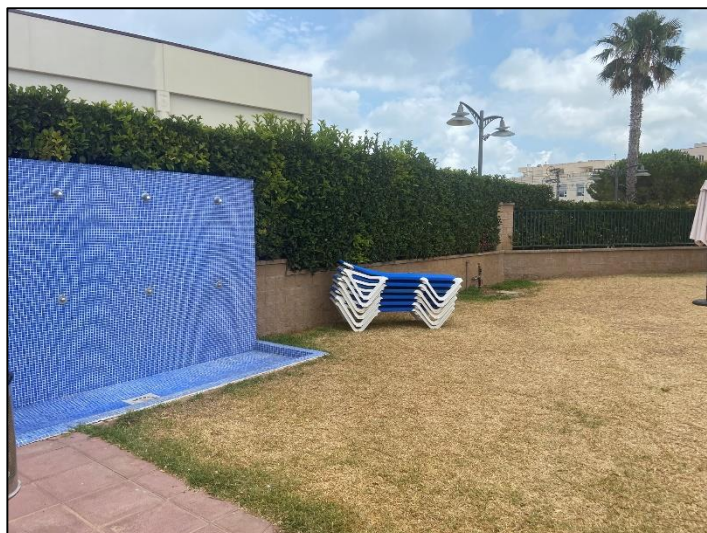
Figura núm. 6. Estat actual de les dutxes de la piscina
