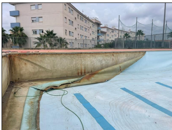
Figura núm. 2. Estat actual deficient de la piscina
