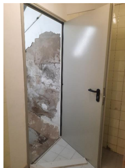
Porta tallafocs d'accés a la pl. soterrani
