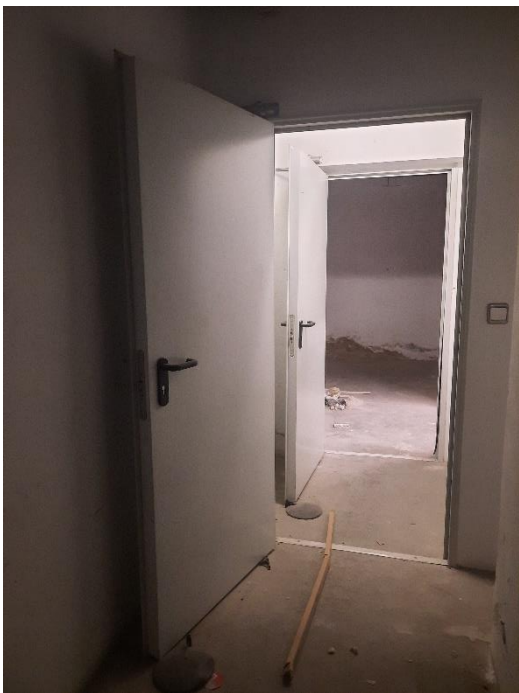
Vestíbul d'independència previ a l'accés a les sales 1,2, i 3, amb portes tallafocs EI2 60-C5
