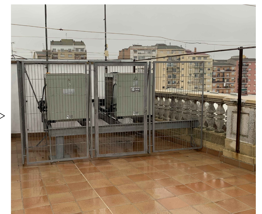
IMATGE UNITATS CLIMATITZACIÓ EXTERIOR
