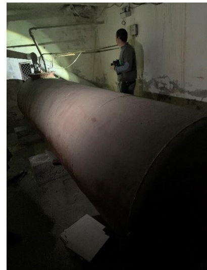
Dipòsit de gasoil existent en pl. soterrani (a suprimir)
