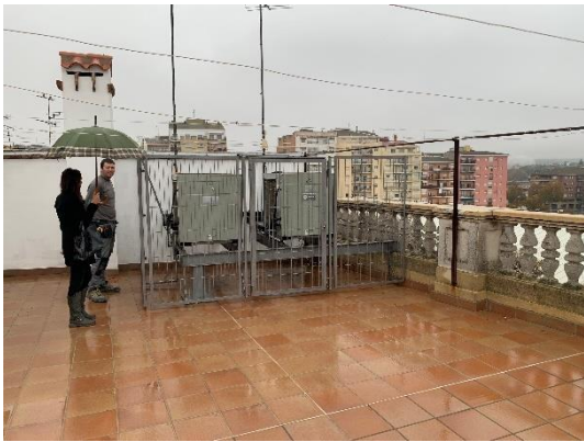
Refredadores existents a la coberta (a substituir)
