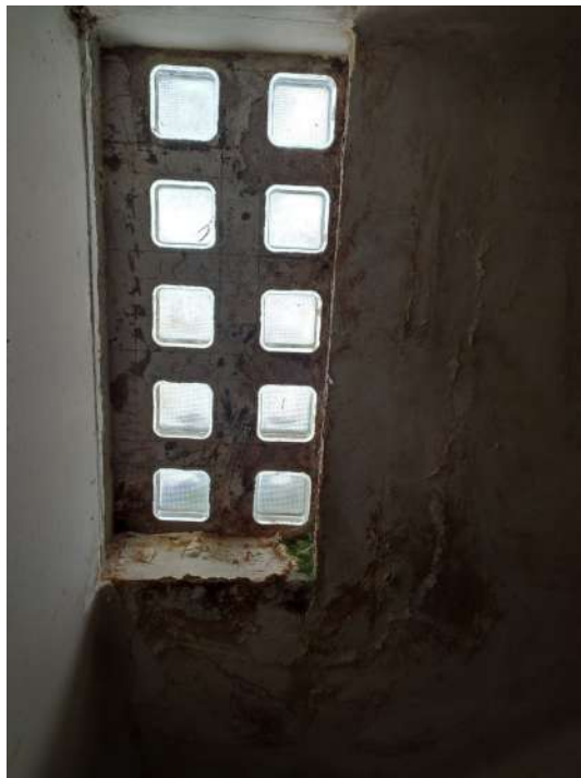
Foto 7: Patologia de filtracions dels lluernaris
