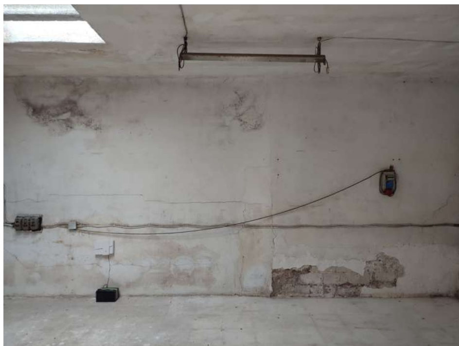
Foto 4: Mur perimteral Nord: en contacte amb el terreny amb patologies d'humitat per filtracions i fissures
