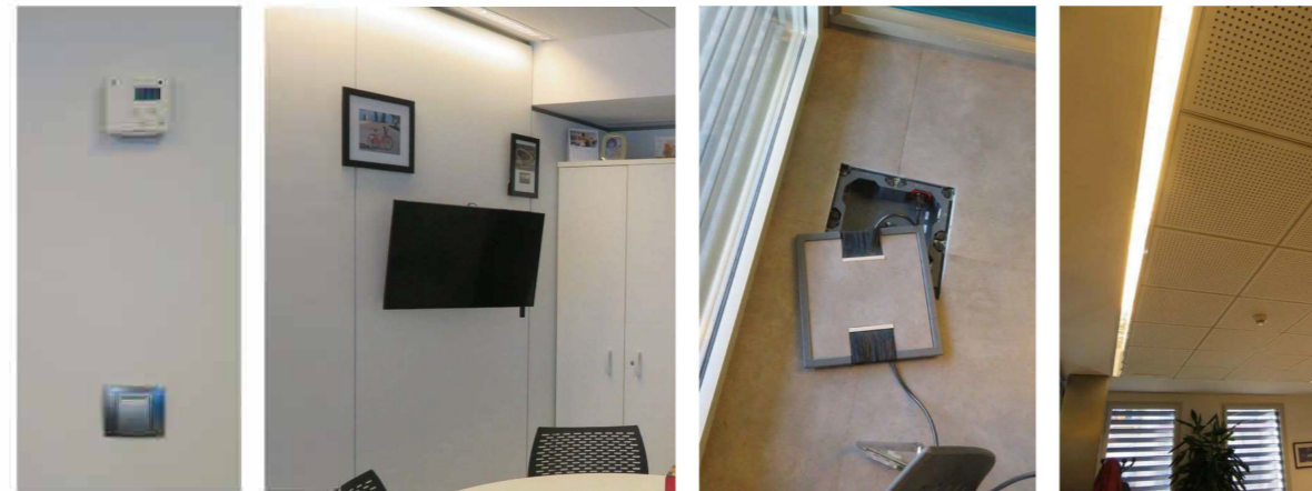
1. Termòstat i inter. 2. Monitor a desmuntar. 3. Caixes de terra a reubicar. 4. Il·luminació a modif.
