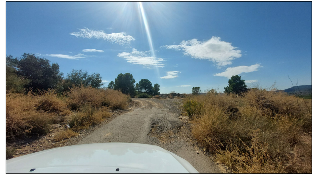
Fotografia Georeferenciada, sot molt importatnt que caldra reparar abans del reg asfàltic d'acabat. pk: 0+400
