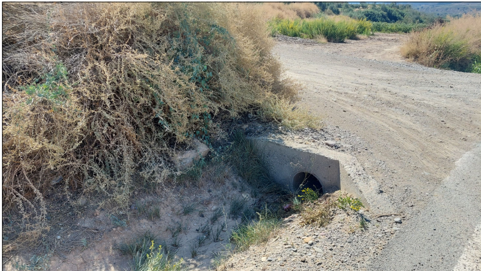
Fotografia Georeferenciada,tub de pas de camí, de recollida existent cuneta ctra LV-7045, pk: 1+740
