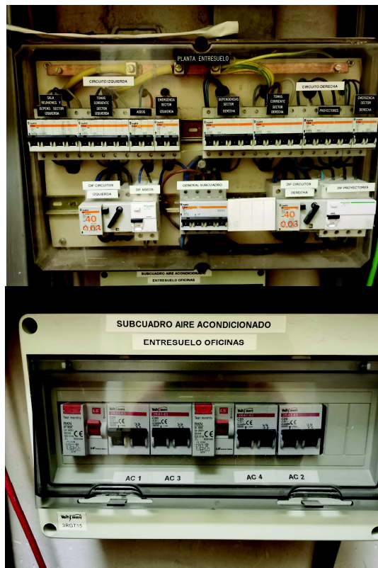
Subquadre elèctric entresol
