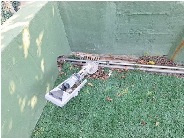
Sistema de reg a substituir
