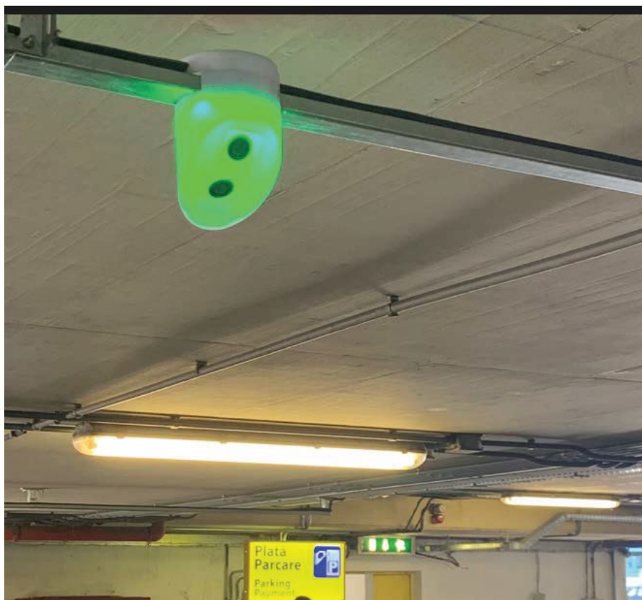
Foto. Detalle anclaje sonda a techo aparcamiento
