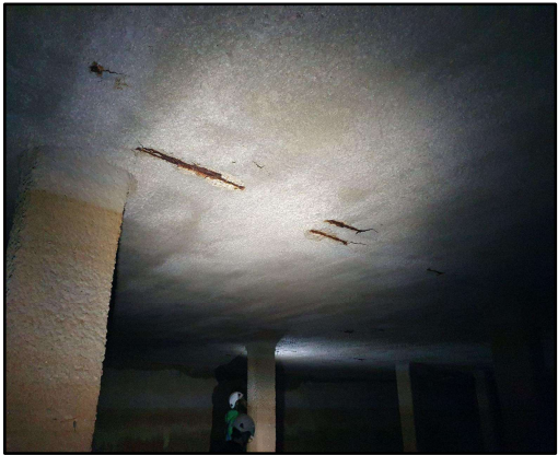
2-falta de recobriment en armat de coberta
