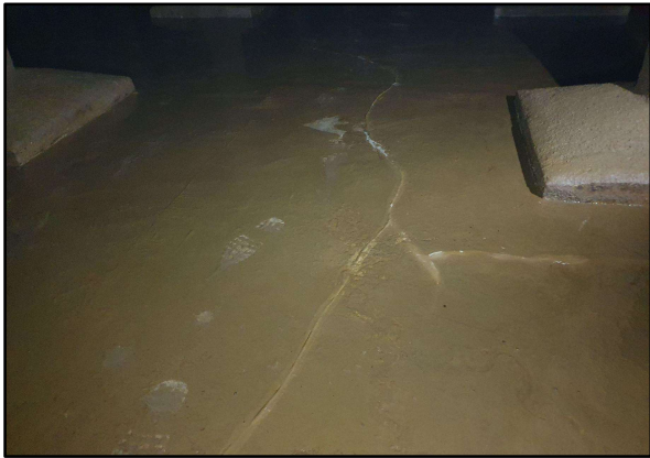
1. esquerdes en solera del dipòsit
