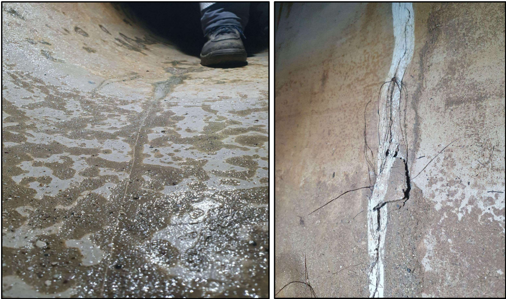
3. esquerdada en trobament horitzontal-vertical 4. esquerdada en parament vertical
