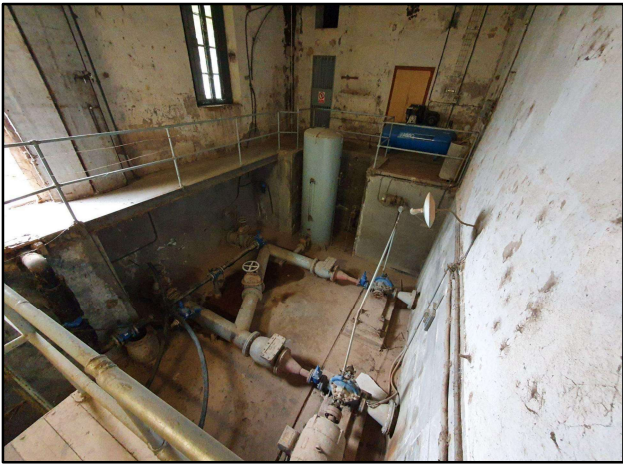
1. sala de calderí (antiga ETAP)
