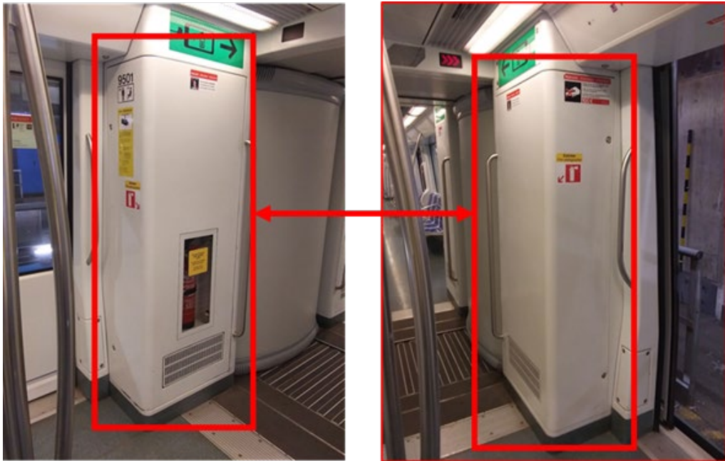
Figura 3.8. Portes d'armari elèctric i extintor S/9000
