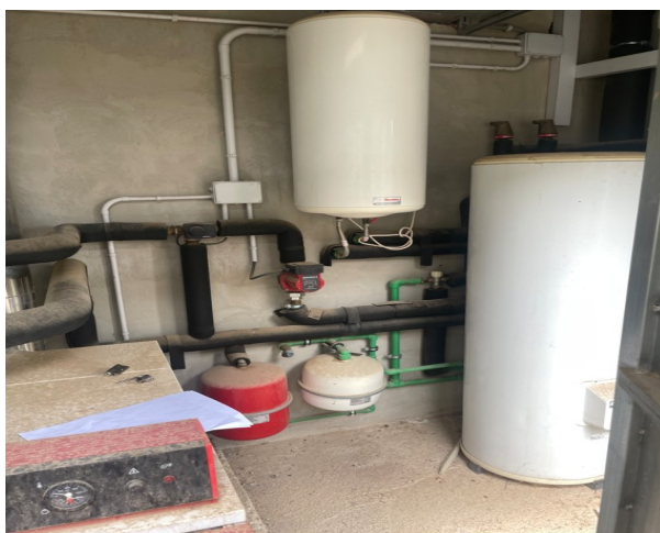
Figura 2: Sala de calderes
