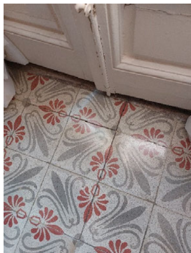
Fusteria P3 Comerç; afectació paviment
