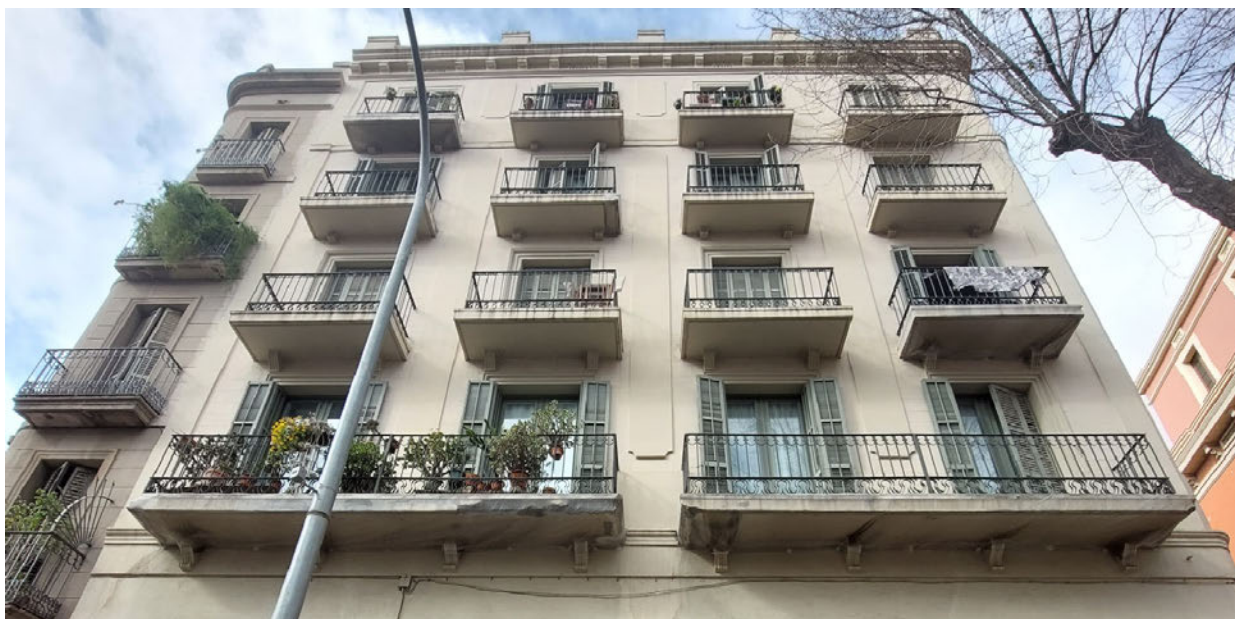
Despreniments del revestiment de la llosa dels balcons en P1 façana Comerç
