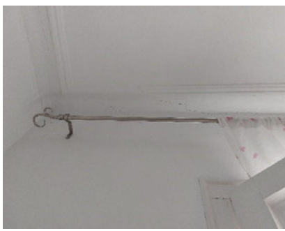
2on. Esquerda i fissures cel ras
