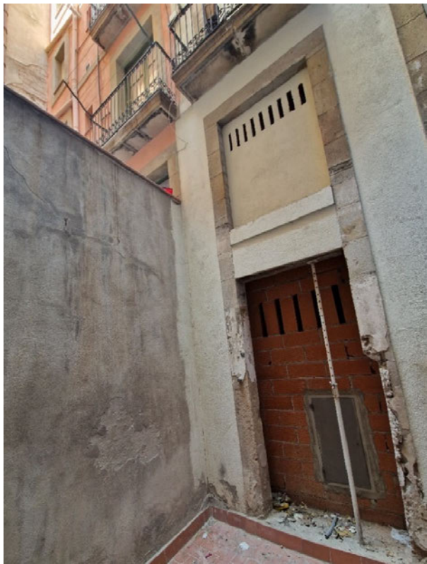
PB- Obertura a Pati - Manca de lbrancal en obertura
