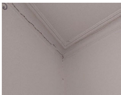
3er. Esquerda encontre envà-façana i cel ras
