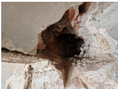
PA- Detall oxidació bigueta
