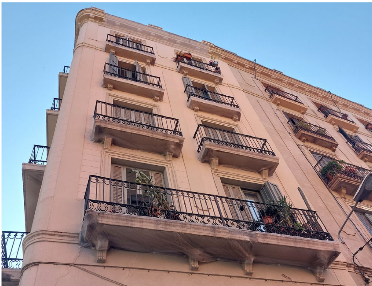
Despreniments del revestiment de la llosa dels balcons en P1 façana Comerç. Armat perimetral en balcons rehabilitats al 2009
