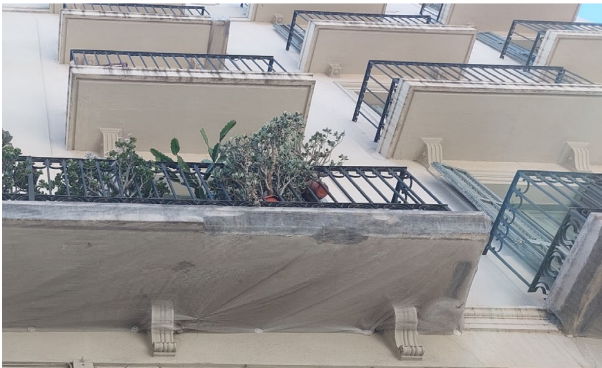
Despreniments del revestiment de la llosa dels balcons en P1, P2, P3 i P4 de la façana Pons i Clerch
