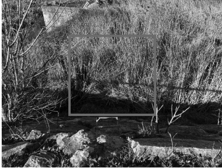
Il·lustració 5. Imatge de l'estat de la captació d'aigua tapada per la vegetació. Data: 12/03/2024
