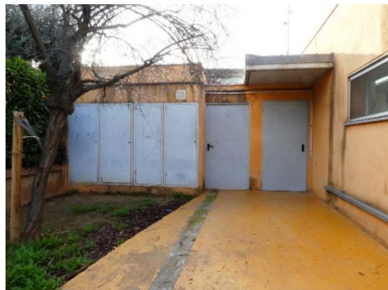
Vista de l'accés de servei i armaris d'escomeses.
