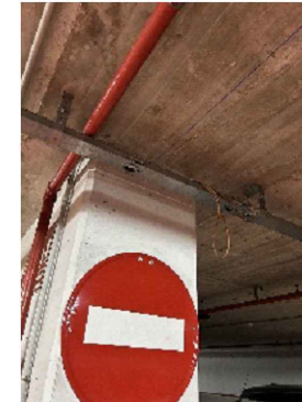
41- Cablejat safata metàl·lica
