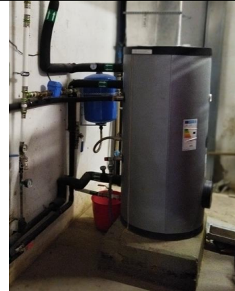
Acumulació ACS dins sala de calderes
