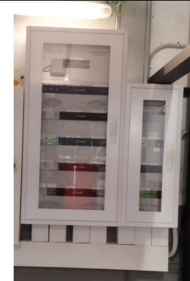
Quadre de Control LOXONE
