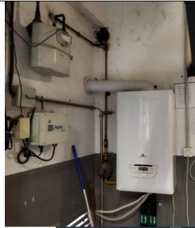
Instal·lació ACS i gas dins sala de calderes
