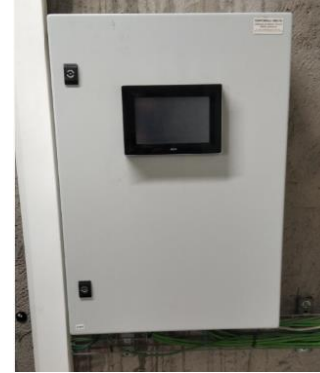
Quadre control CONTROLLI dins sala de bombes
