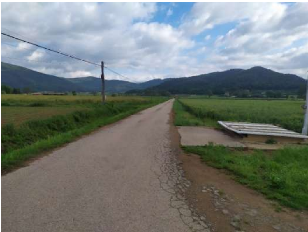
Foto 4: PK 0+000 a PK 0+390. Camí en mal estat.
