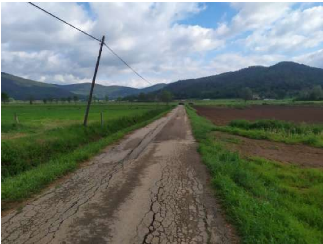
Foto 2: PK 0+000 A PK 0+250. Camí en molt mal estat
