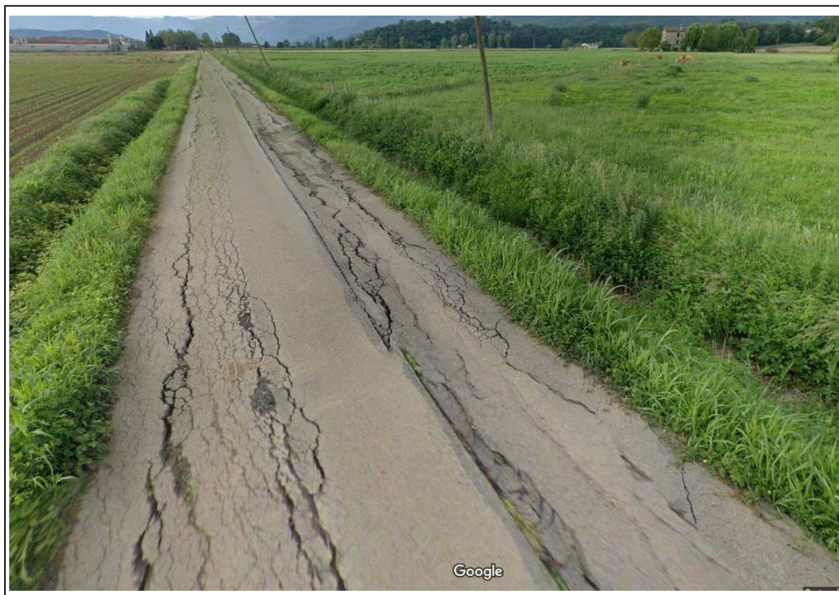
Figura 1. Aspecte del paviment del vial
