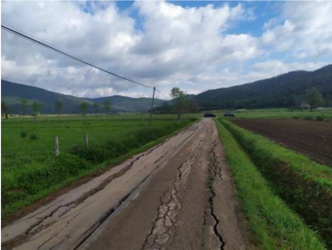
Foto 1: PK 0+000 a PK 0+150. Camí en molt mal estat
