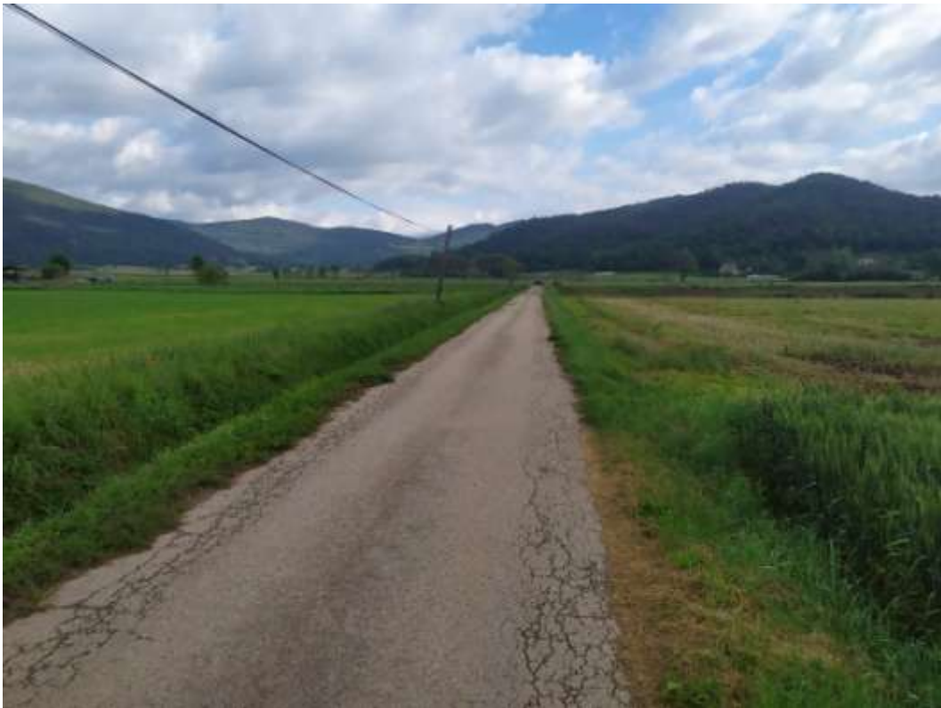
Foto 3: PK 0+000 a PK 0+300. Camí en mal estat
