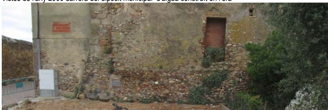
Vista de la façana de planta baixa l'any 2019 un cop enderrocat el dipòsit municipal i abans de l'adequació de la placeta
