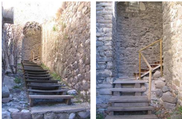
Vista de l'escala provisional de fusta molt degradada
