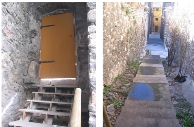
Vista de la porta i escala de fusta provisional. El graonat de fusta provisional i degradat
