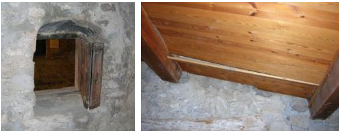
Fusteria existent, manca d'estanqueïtat. Degradació de l'empostissat de fusta interior
