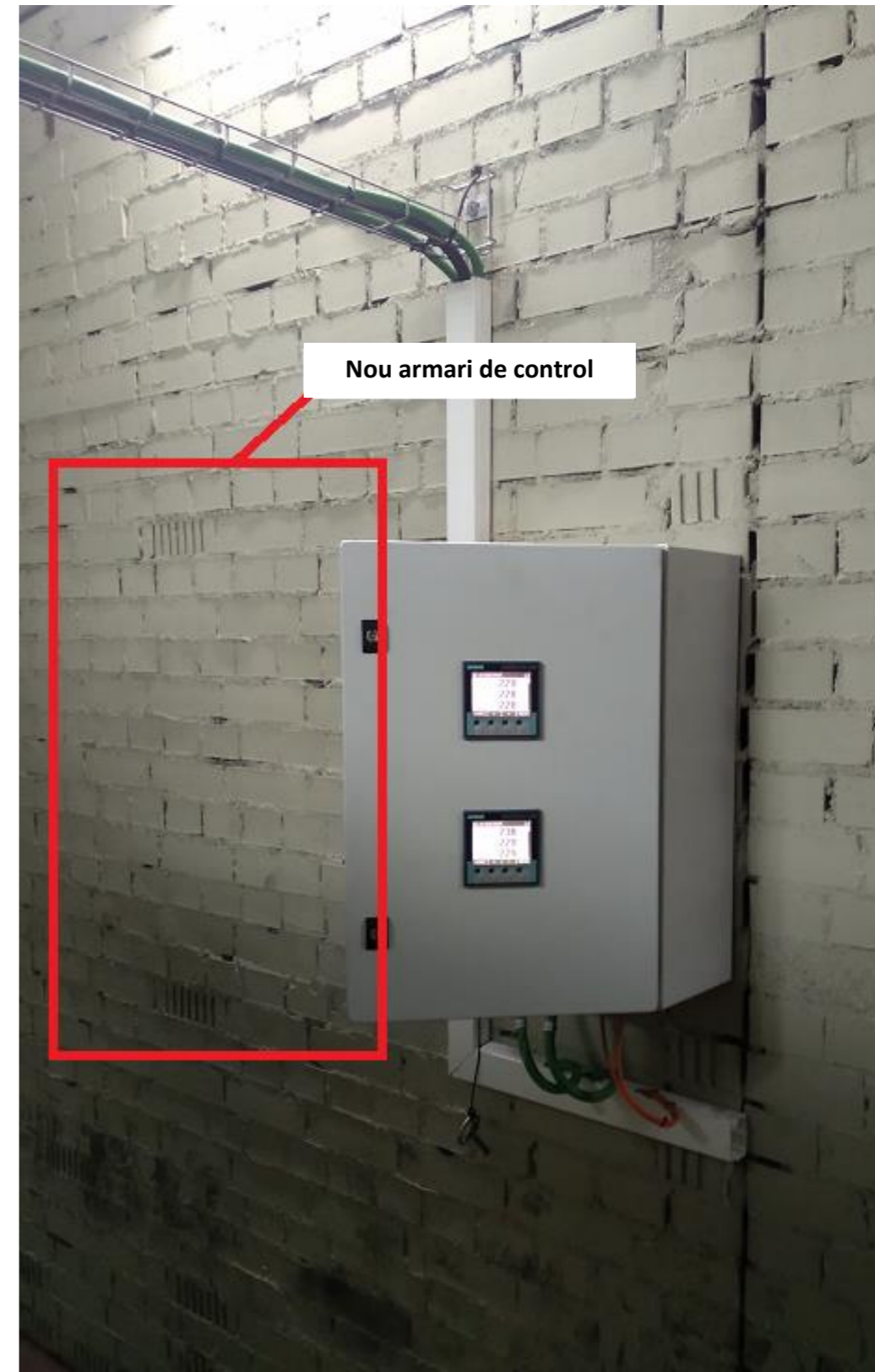
Ubicació del nou armari de control
