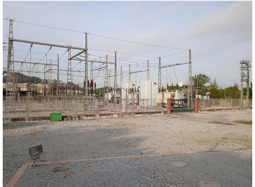
Il·lustració 2: Estació transformadora. Vista frontal des de la via principal
