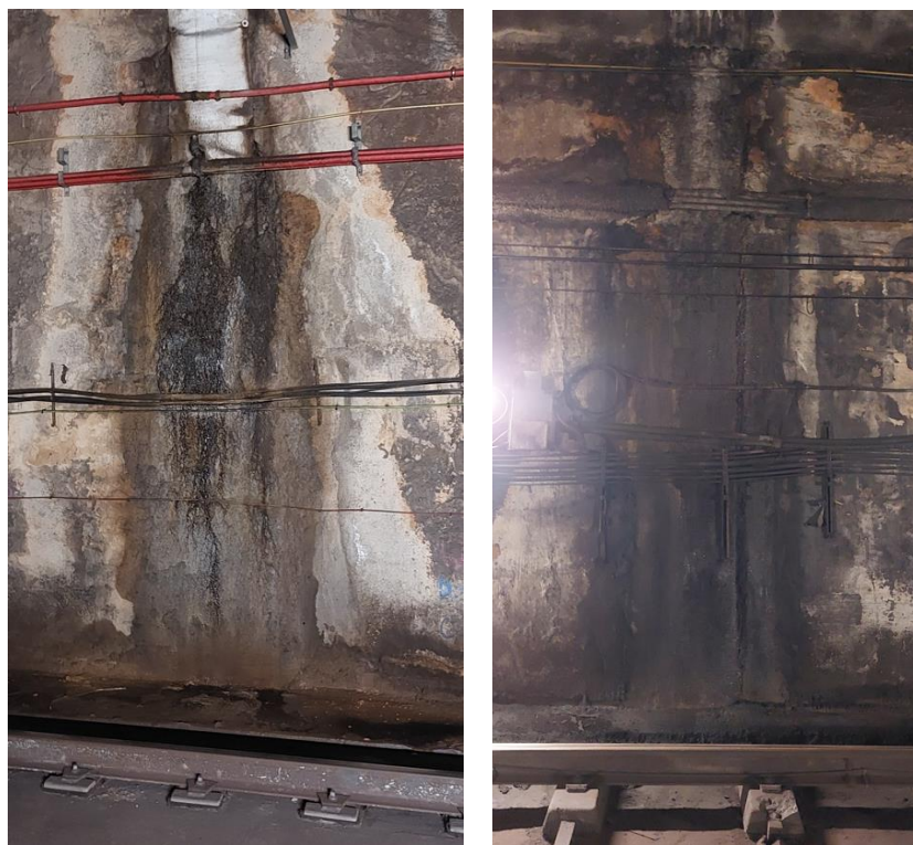
Imatge 3. Fotografies de filtracions al tram Verneda-Sant Roc de L2
