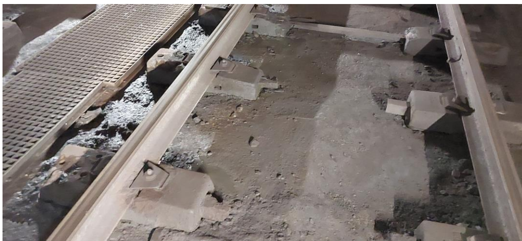
Imatge 2. Fotografia exemple travesses bibloc deteriorades
