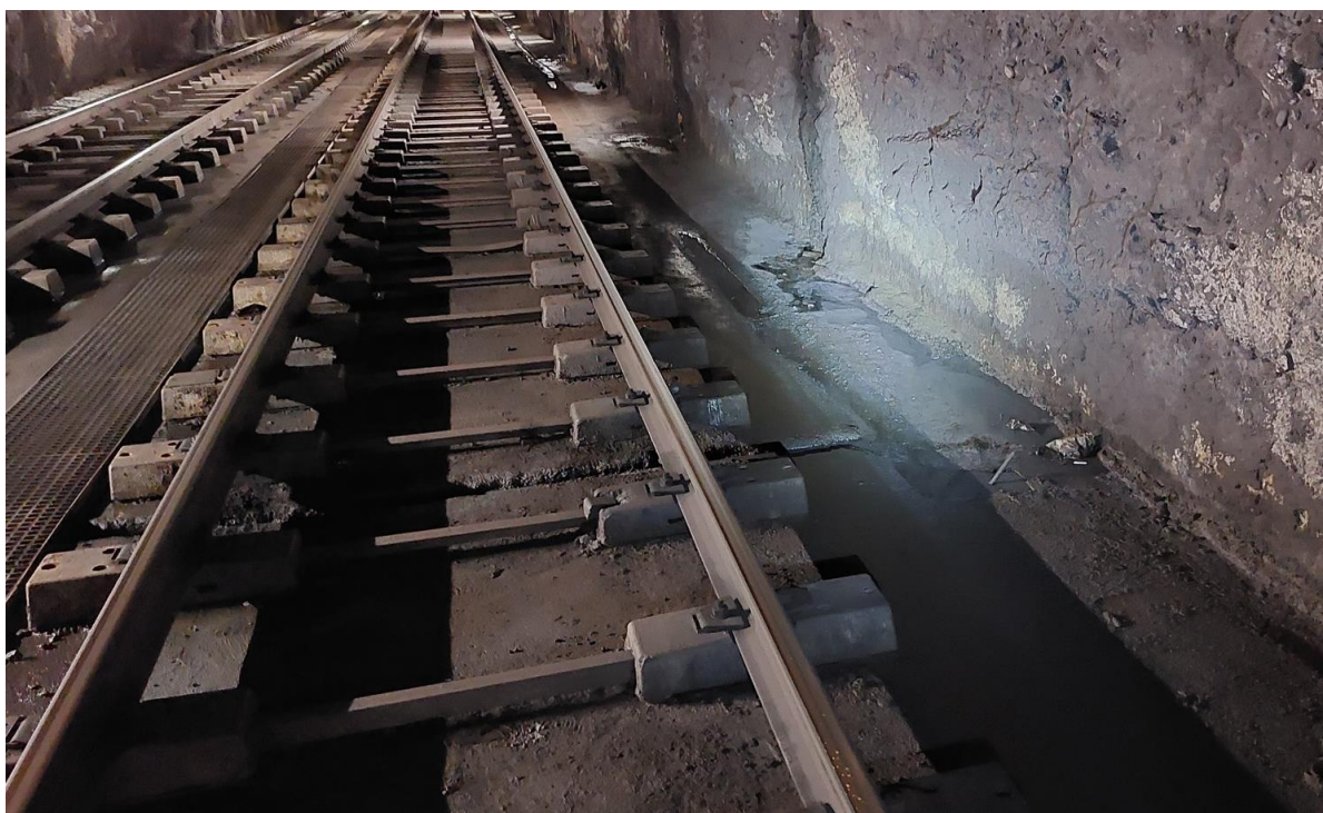
Imatge 12. Punt acumulació aigua al PK109+235 amb drenatge transversal insuficient.
