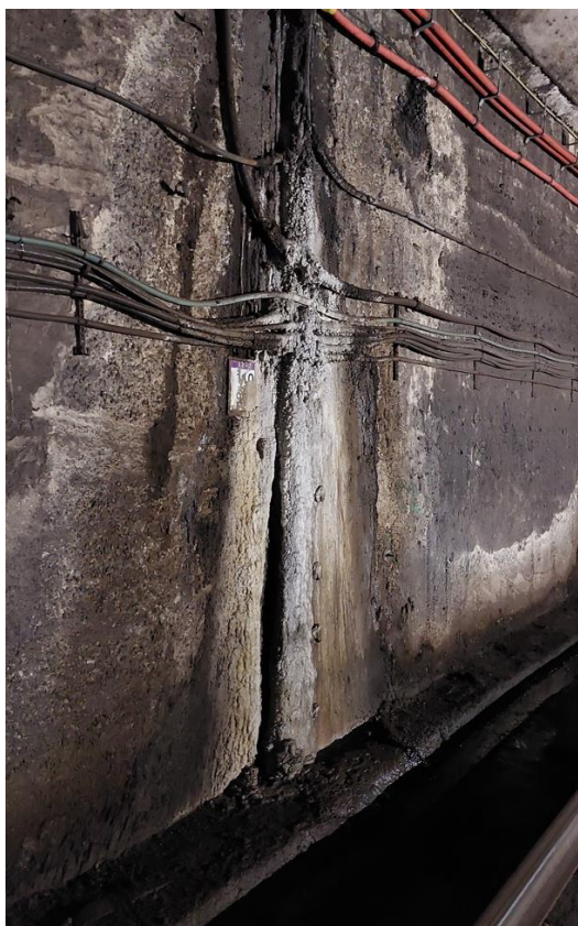
Imatge 16. Filtració PK110+900 hastial via 1
