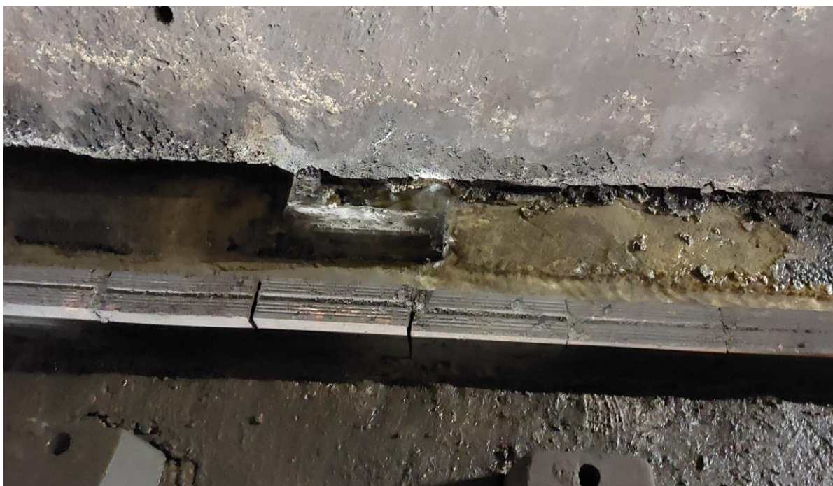
Imatge 18. Imatge filtració PK110+470 coincident amb tram via travesses STEDEF.
