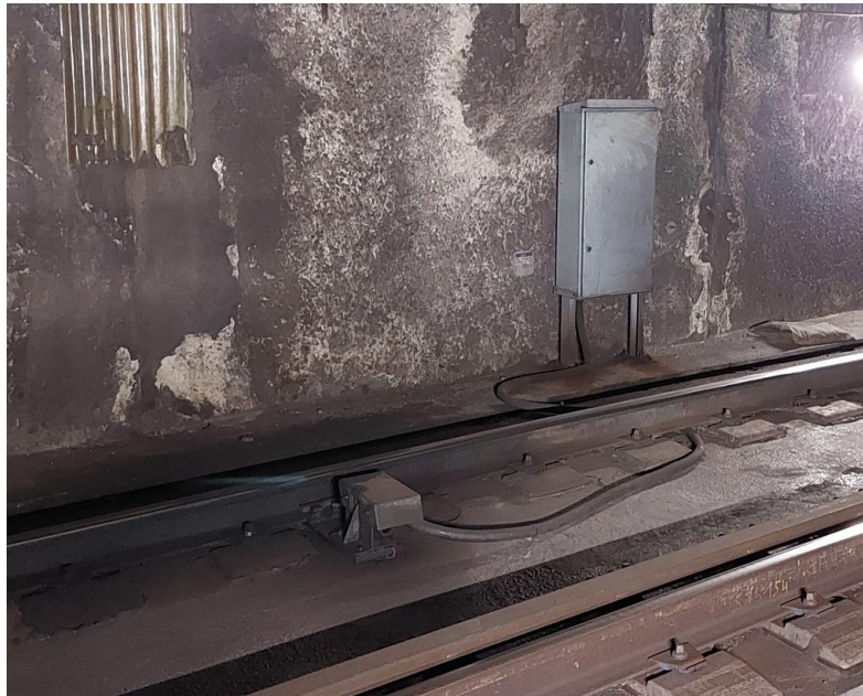
Imatge 4. Fotografia tipus greixador actual a línia 2
