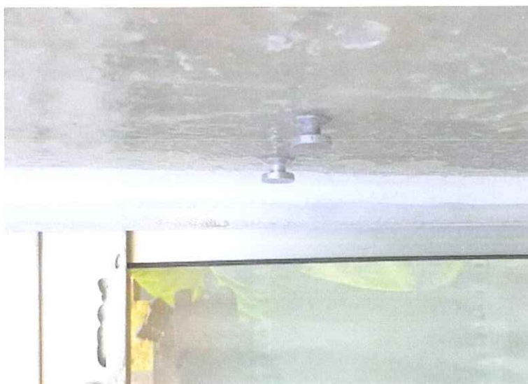
Superficie arrancada de resina
