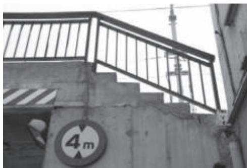
Imatge 5: Detall de la barana i les fissures a reparar
