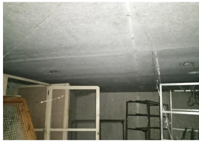
cambres frigorífiques amb coberta de plaques de fibrociment amb amiant
