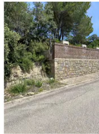
V2. Carrer Peguera, manca de vorera Font: GAA (04/07/2024)
