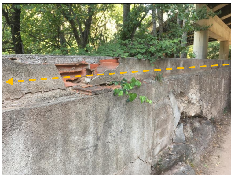
FOTO 20. Detall del mur per on discorre la canonada de clavegueram
