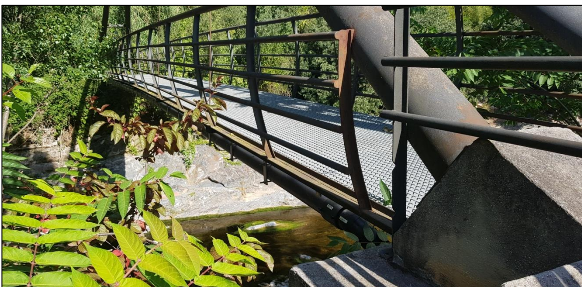
FOTOS 27. Passarel·la sobre el riu Congost, on s'observen les canonades dels serveis d'aigua i clavegueram hi van penjades
