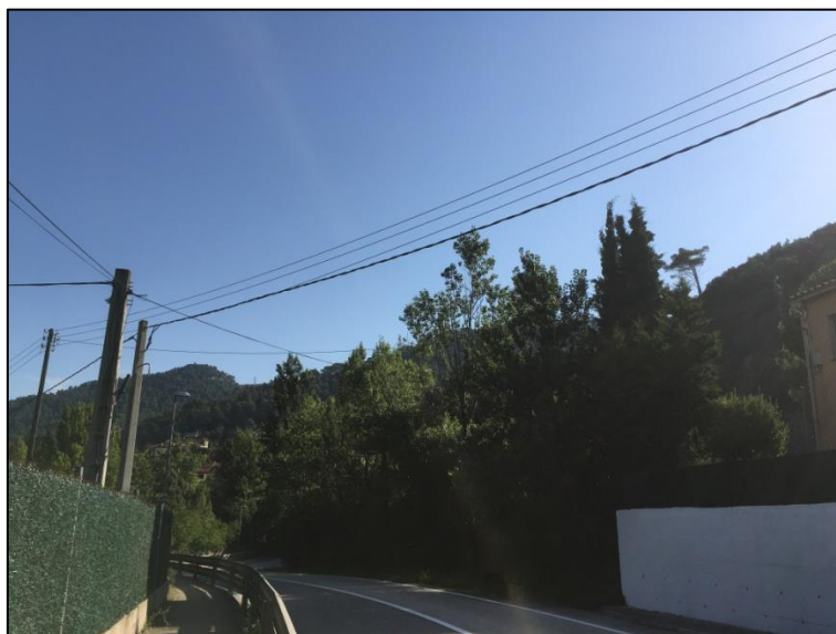
FOTO 35. Línies aèries d'electricitat i telèfon que creuen la carretera N-152a
