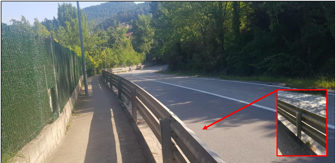
FOTOS 33a i 33b. S'observa que la bionda no compleix normativa
