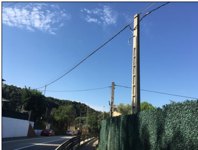
FOTO 34. Línies aèries d'electricitat i telèfon que creuen la carretera N-152a
