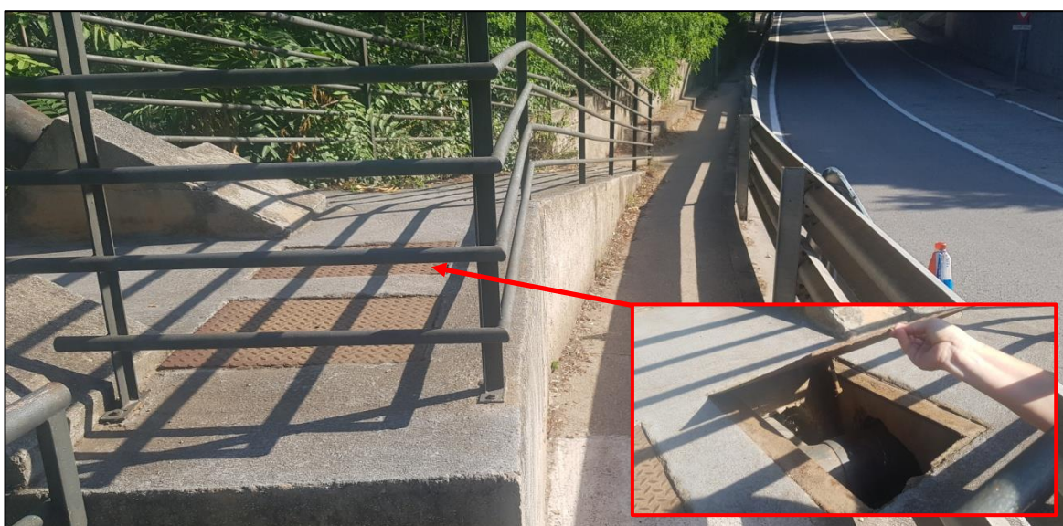
FOTOS 26. Tapes de registre de les canonades d'aigua i de clavegueram que creuen el riu per la passarel·la
