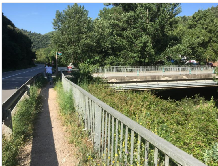
FOTO 65. Pont sobre el riu Congost, on s'observen les canonades dels serveis d'aigua i electricitat que hi van penjades
