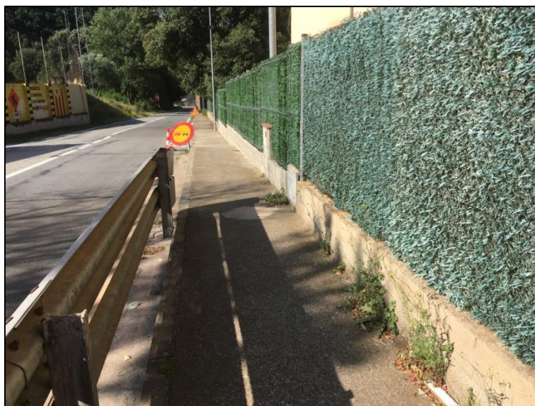
FOTO 38. Fi del tram protegit amb bionda
