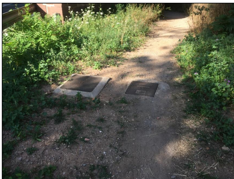
FOTO 48. Tapes de registre de línia elèctrica soterrada
