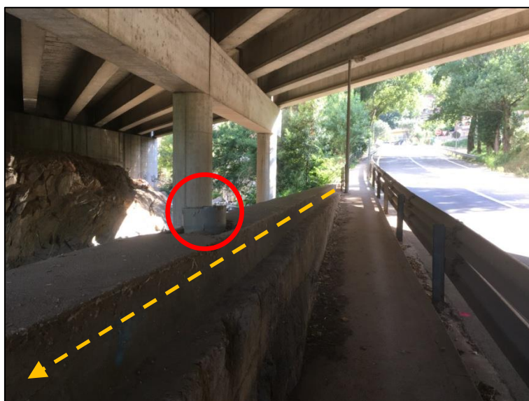
FOTO 17. Una canonada d'aigües residuals (clavegueram) passa per sobre el mur del pas inferior de l'autovia C-17
