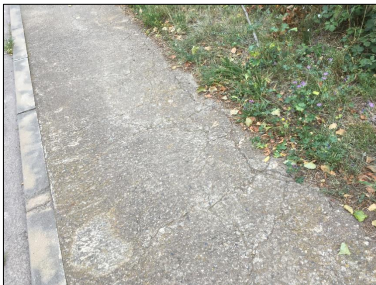
FOTO 60. Detall de l'estat del paviment de formigó
