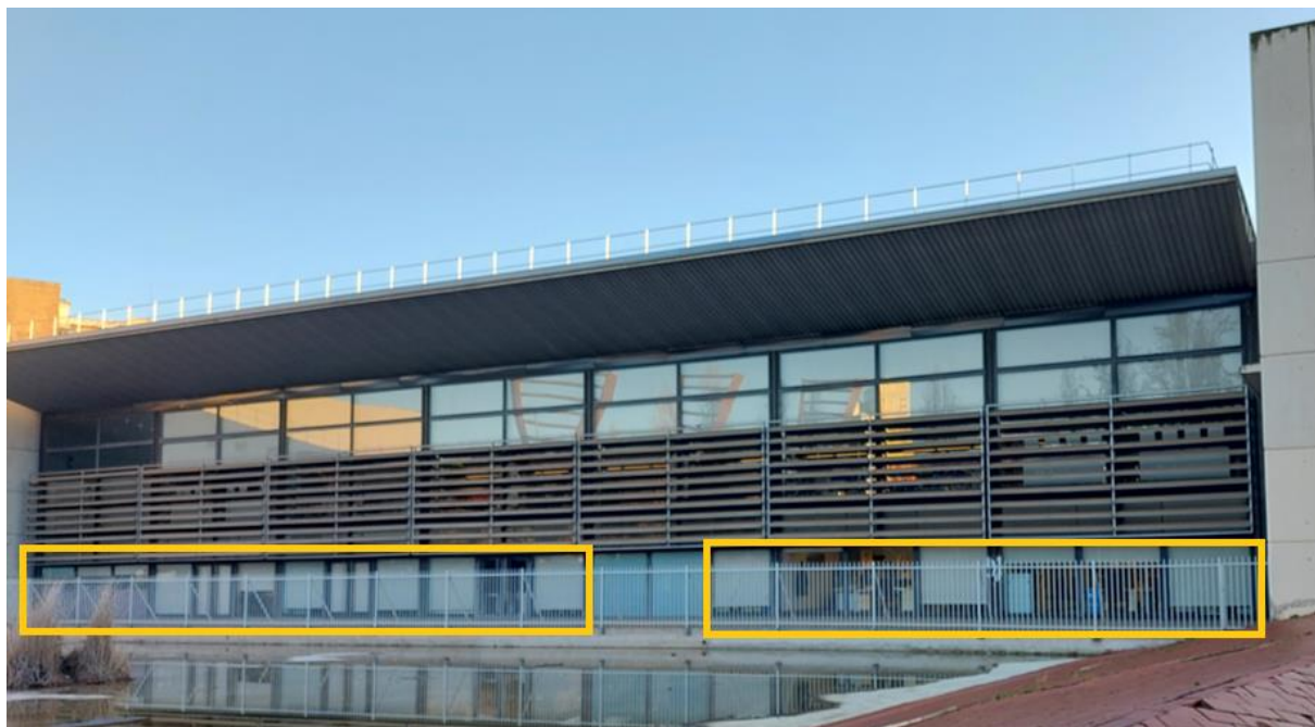
Figura 9: Façana oest Parc Tecnològic, zona amb groc on cal instal·lar les làmines de protecció solar
