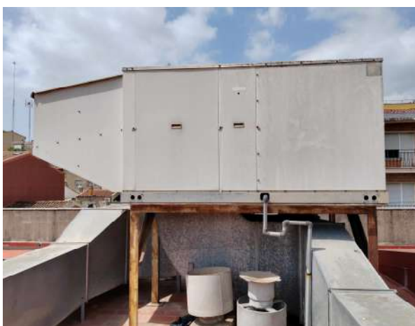
Màquina actual. Roca YORK model: B2IH180A50 E1
