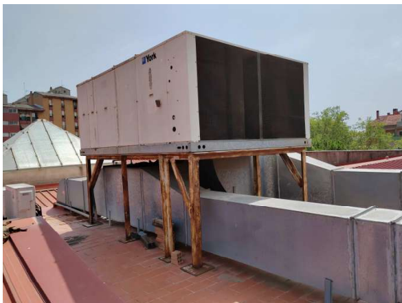
Màquina actual. Roca YORK model: B2IH180A50 E1
