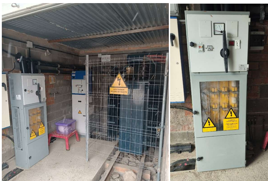
Fig. 27 Vista centre de transformació i quadre baixa tensió connexió cablejat CA inversors
