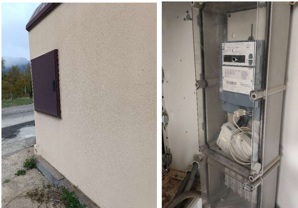
Fig. 28 Vista centre de mesura de l'estació d'esquí i ubicació comptador i mòdem de lectura
