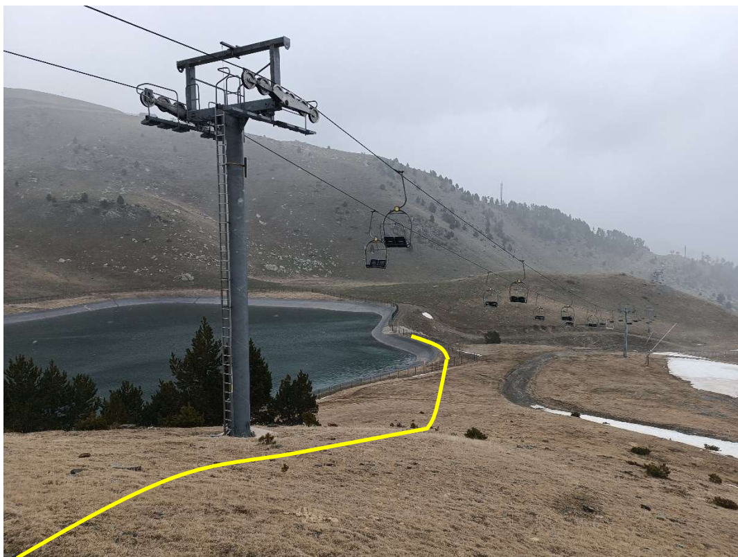
Fig. 24 Vista recorregut rasa cablejat CC
