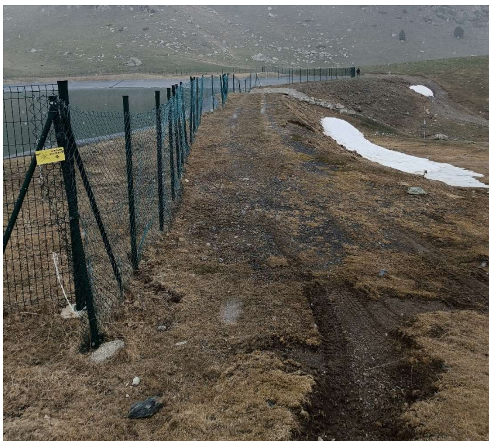
Fig. 23 Vista recorregut rasa cablejat CC
