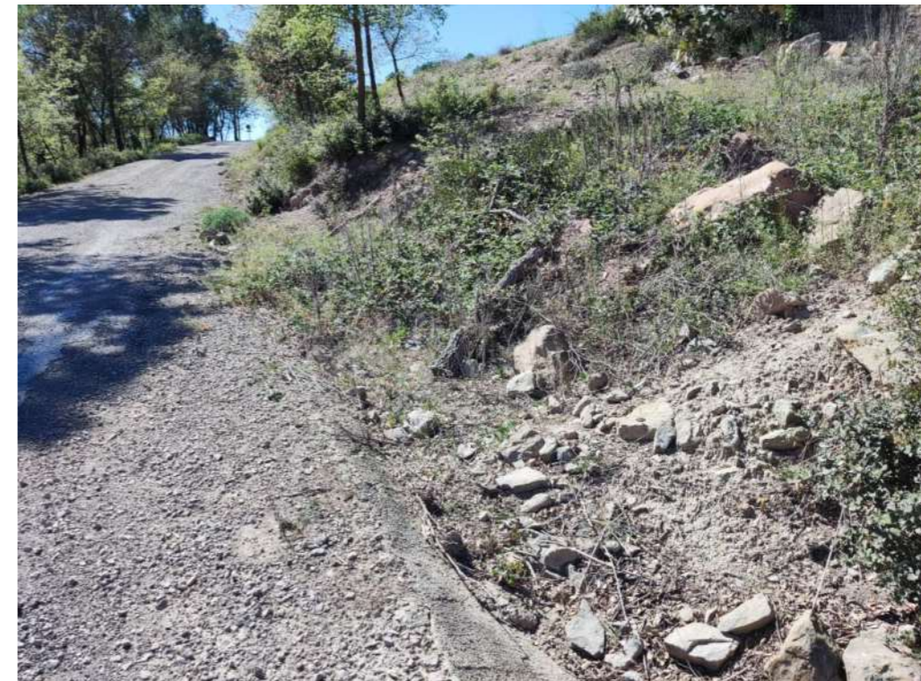
Figura 7. Estat del talús de formigó, on es poden observar varis elements que obstrueixen el pas.
