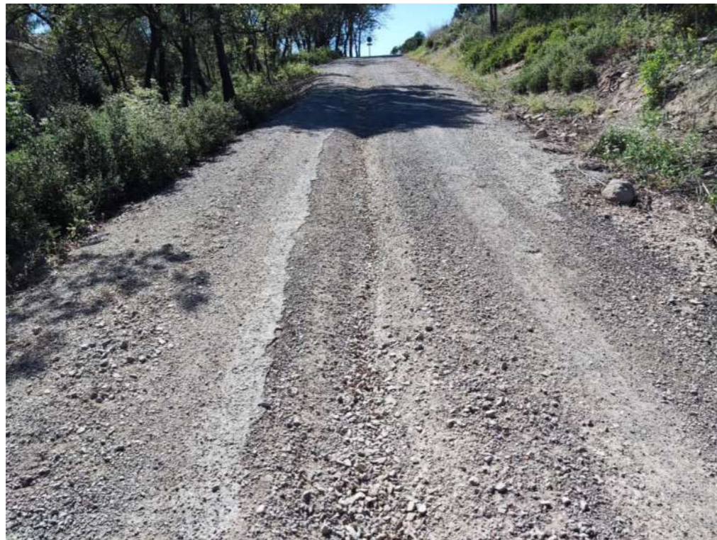
Figura 8. Enfonsament de la calçada per erosió d'aigües pluvials i pas de vehicles pesats agrícoles.
