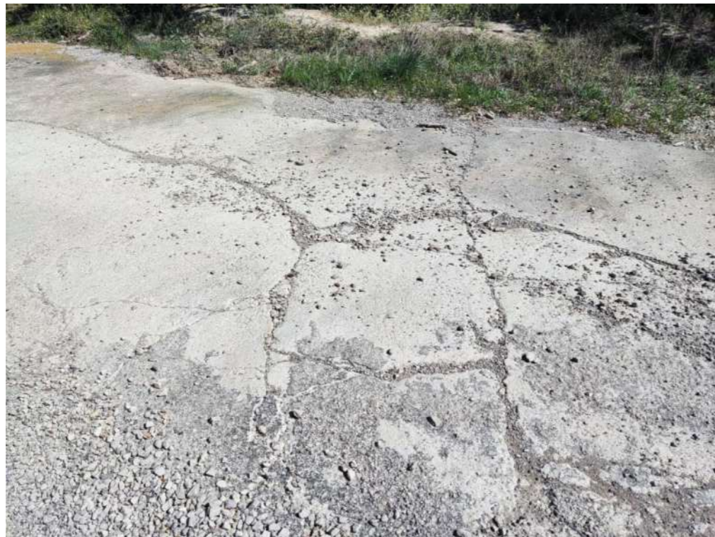
Figura 5. Detalls del gual de formigó, on es pot apreciar una gran esquerda transversal.
