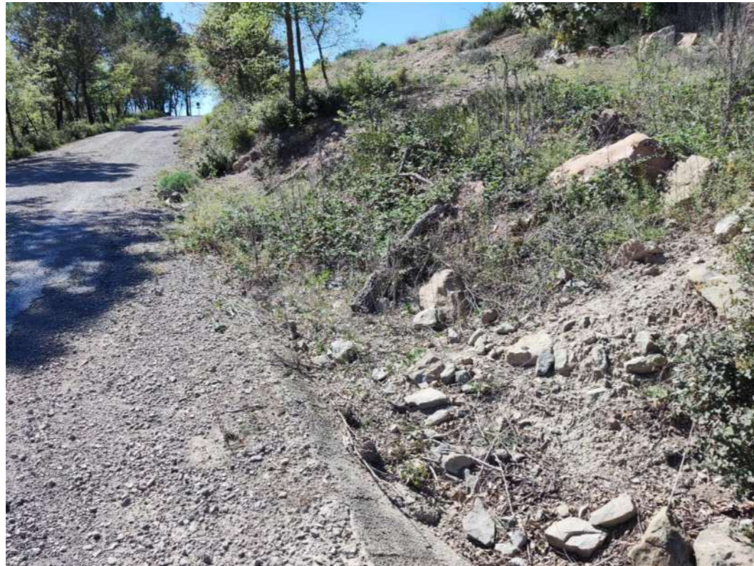
Figura 14. Estat actual de la cuneta nord, on es pot apreciar la vegetació present.
