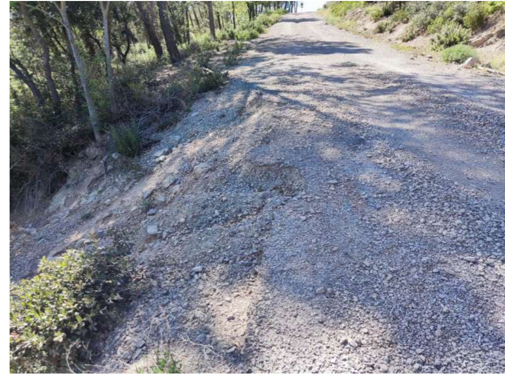
Figura 6. Erosió greu de la via, cap al sud, on es pot veure la plataforma ensorrada.
