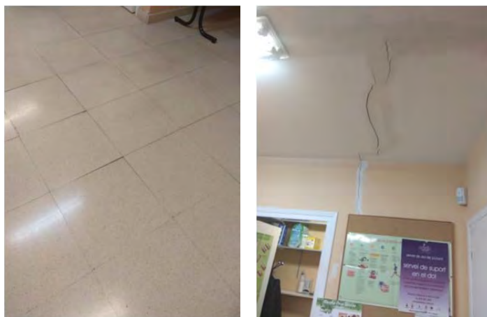
Fotos de la sala d'espera amb danys en el paviment, sostre i parets
