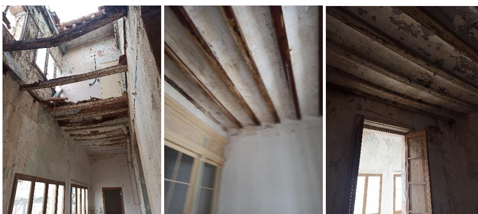
Imatges del forjat de planta 1. A l'esquerra, es pot veure l'estat del forjat de la planta 2 del forjat de tribuna oest, així com la part de coberta que falta. A la dreta, el sistema constructiu de volta que constitueix el sistema constructiu dels forjats. Fotos: 27/02/2023.
