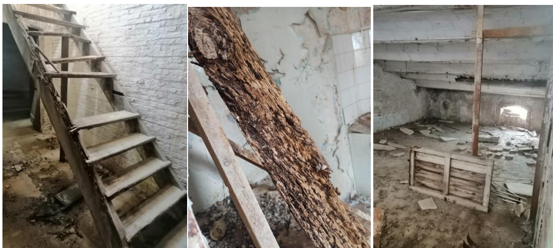
Imatges de l'estat de conservació dels diferents materials a la coberta. Fotos: 27/02/2023
