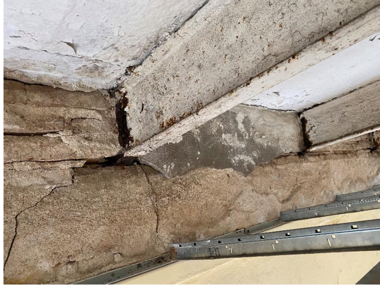
Il·lustració 11.- patologia en el cap de les biguetes
