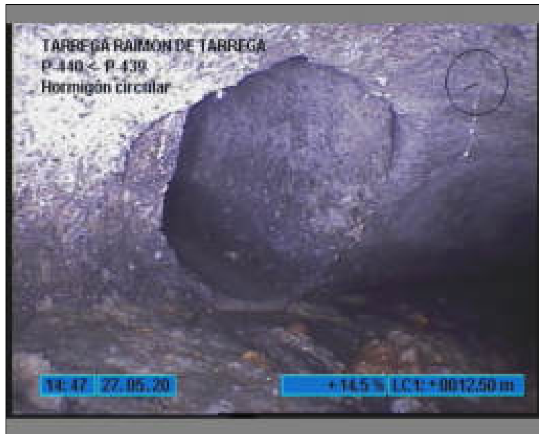
Foto: 9_9_57_A.JPG 12,5m, ACOMETIDA LADO IZQ., con 1 conexiones de acometidas , a 9 h.
