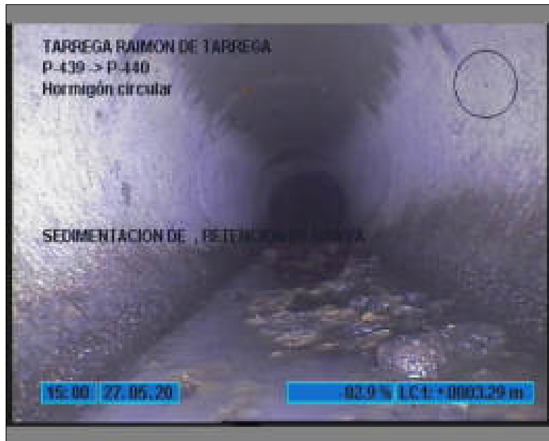
Foto: 10_10_60_A.JPG 3,2m, SEDIMENTACION DE , RETENCION DE GRAVA. HAY QUE LIMPIAR.
