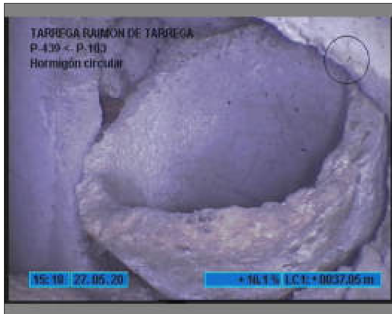
Foto: 11_11_70_A.JPG 37m, ACOMETIDA LADO DCHO., con 1 conexiones de acometidas , a 1 h.
