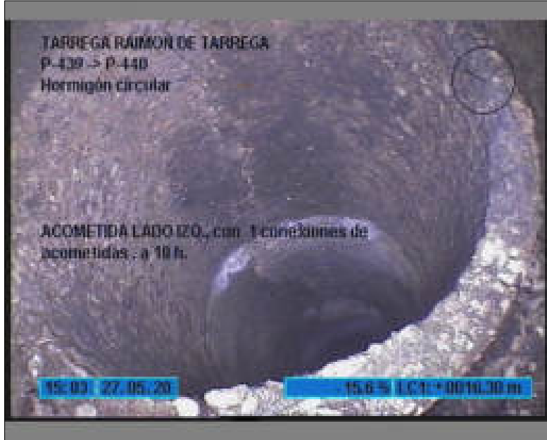
Foto: 10_10_63_A.JPG 16,3m, ACOMETIDA LADO IZQ., con 1 conexiones de acometidas , a 10 h.
