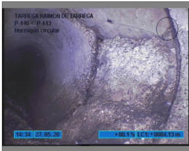
Foto: 8_8_49_A.JPG 4,1m, OTROS DEFECTOS EN EL REVESTIMIENTO INTERIOR , REPARACION INTERIOR EN MAL ESTADO
