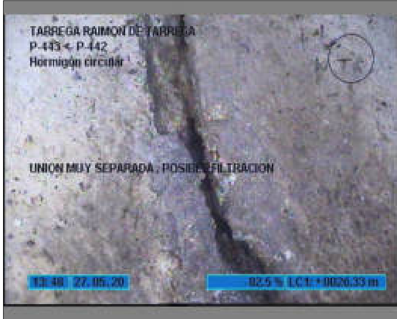
Foto: 7_7_44_A.JPG 26,3m, UNION MUY SEPARADA , POSIBLE FILTRACION
