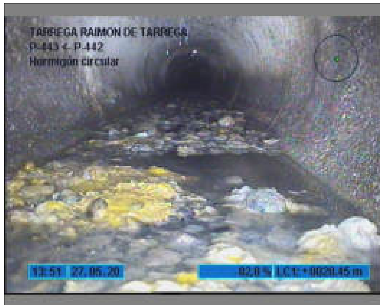
Foto: 7_7_47_A.JPG 28,4m, INTERRUPCION POR SUCIEDAD , ACUMULACION DE GRAVAS EN LA TUBERIA. HAY QUE LIMPIAR.
