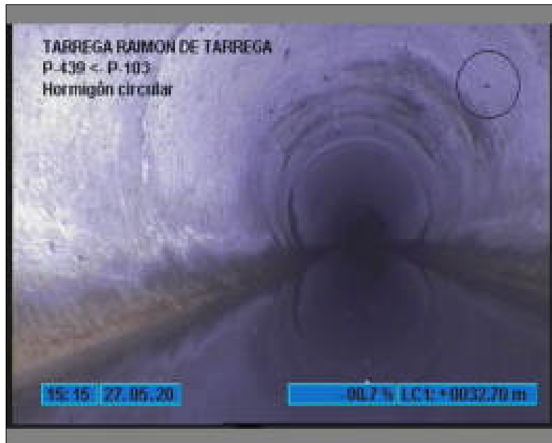
Foto: 11_11_68_A.JPG 32,7m, ALTO NIVEL DE AGUA TURBIA, profundidad de 15%, RETENCION DE AGUA. HAY QUE LIMPIAR.
