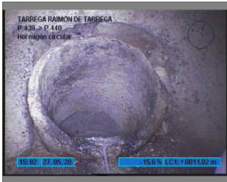
Foto: 10_10_62_A.JPG 11m, ACOMETIDA LADO DCHO., con 1 conexiones de acometidas , desde 1 h. a 2 h.
