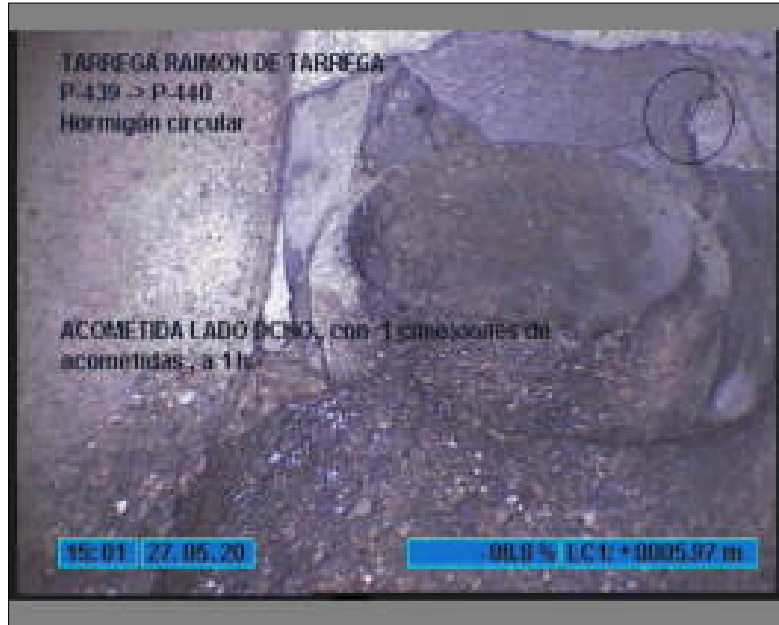
Foto: 10_10_61_A.JPG 5,9m, ACOMETIDA LADO DCHO., con 1 conexiones de acometidas , a 1 h.
