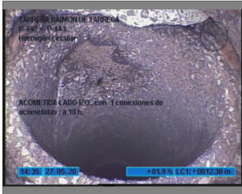
Foto: 8_8_50_A.JPG 12,3m, ACOMETIDA LADO IZQ., con 1 conexiones de acometidas , a 10 h.
