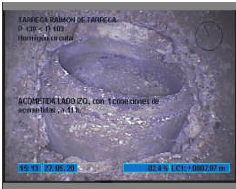
Foto: 11_11_66_A.JPG 7,9m, ACOMETIDA LADO IZQ., con 1 conexiones de acometidas , a 11 h.
