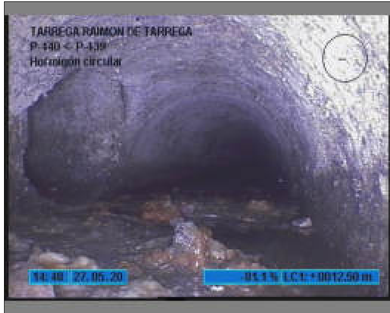
Foto: 9_9_58_A.JPG 12,5m, INTERRUPCION POR SUCIEDAD , TUBERIA AL 50 % DE GRAVA. HAY QUE LIMPIAR.
