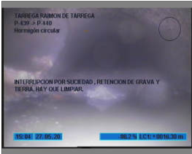
Foto: 10_10_64_A.JPG 16,3m, INTERRUPCION POR SUCIEDAD , RETENCION DE GRAVA Y TIERRA. HAY QUE LIMPIAR.
