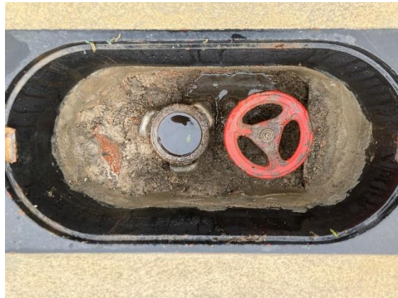
Figura 1. Hidrant del Port de Roses
