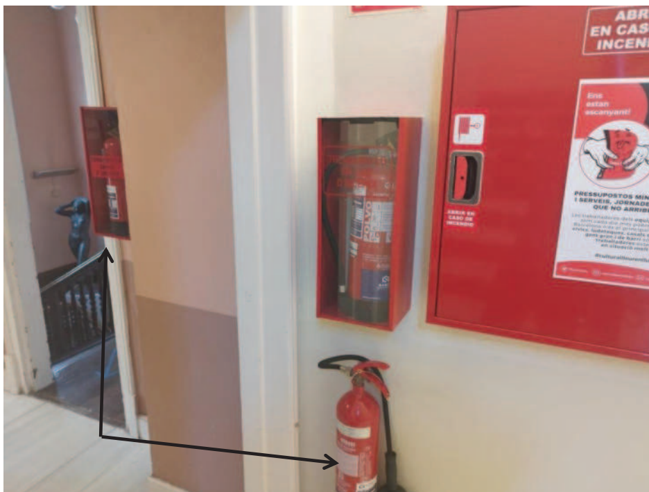
Fotografia 22. Detall dels dos extintors que cal desplaçar.
