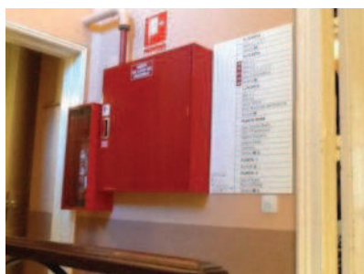
Fig. 71 i 72 Extintors i mànegues d'incendis.
