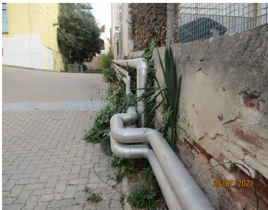
Canalització existent Aerotermos
