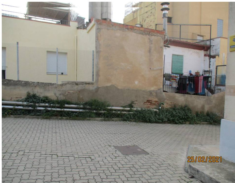
Canalització existent Aerotermos
