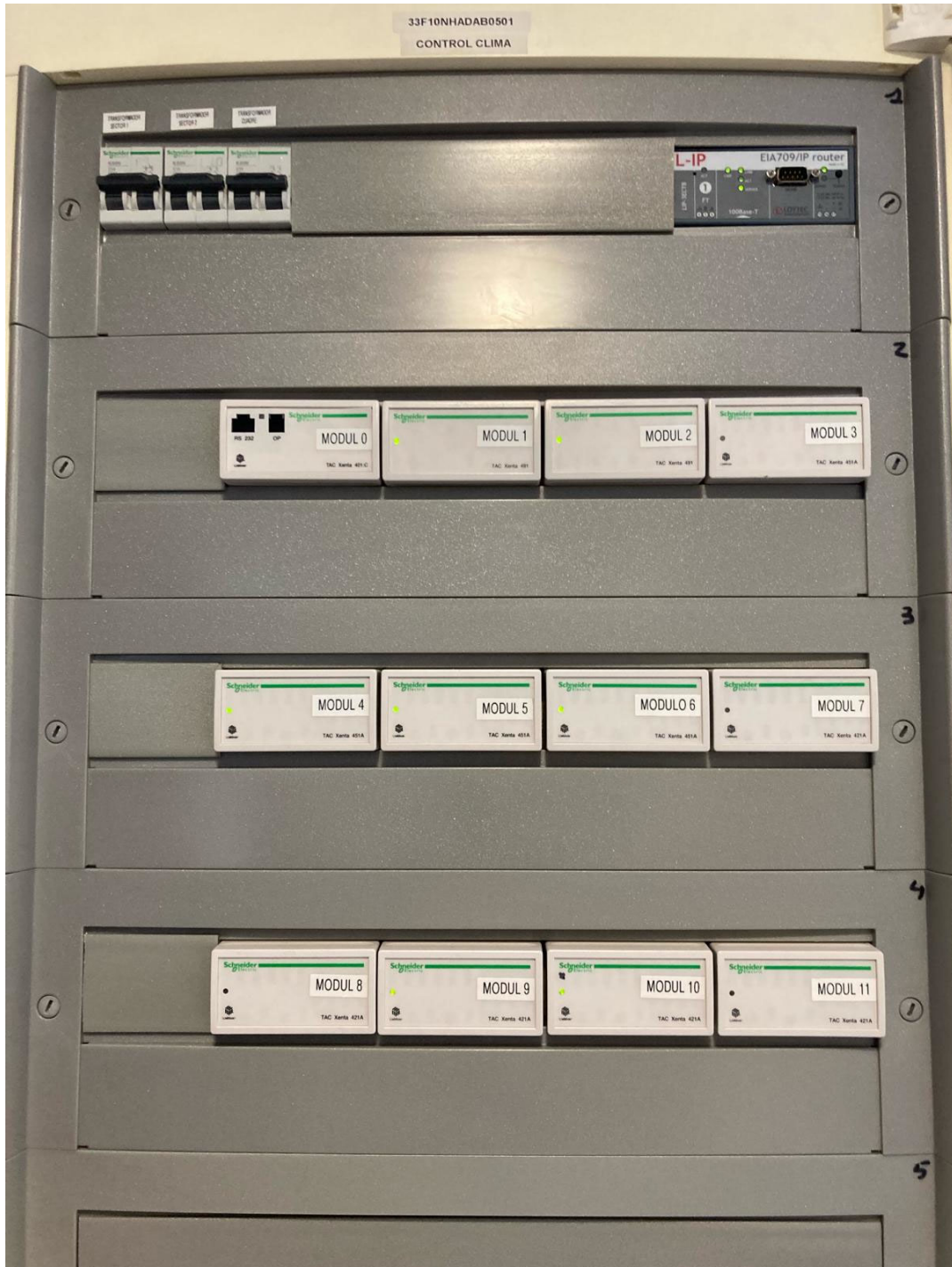
Quadre elèctric de Control.
